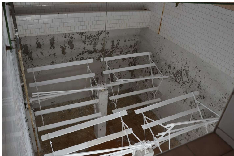
Obr. 21 Vločkovací nádrž – plošně oprýskaný vnitřní povrch nádrže
