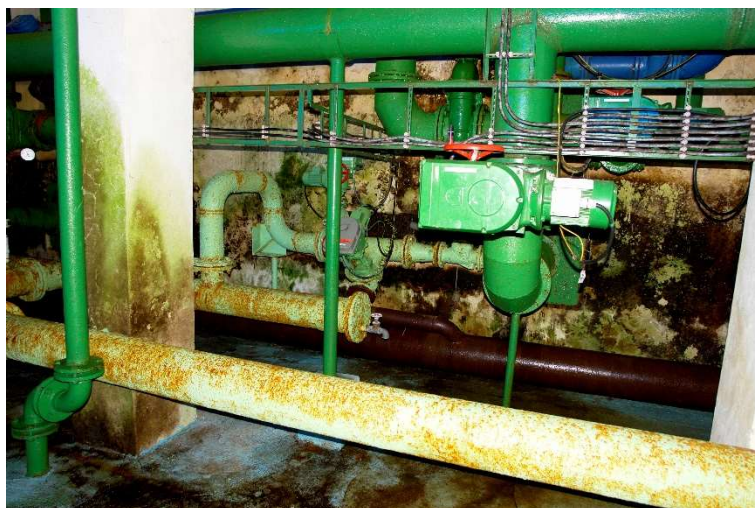
Obr. 18 Armaturní chodba – významný výskyt plísní a nárostů
