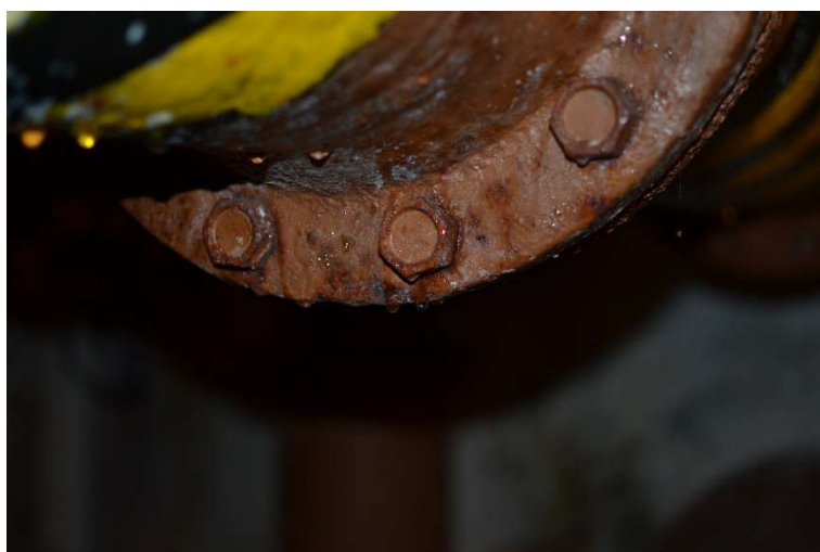
Obr. 37 Netěsnosti spojů na trubním vedení – k faktoru ST2.3
