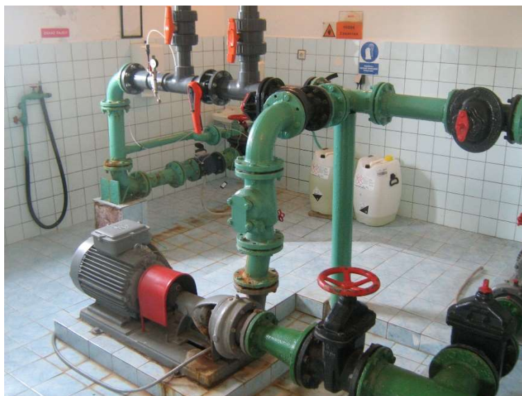
Obr. 26 Čerpadla prací vody – zdrojem prací vody je surová voda
