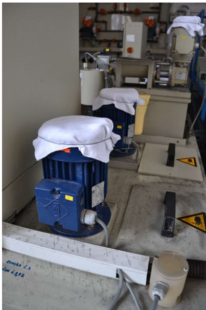
Obr. 29 Ochrana čerpadel před spadem částic práškového aktivního uhlí (nakládání se sypkými hmotami způsobuje zvýšenou prašnost prostředí)
