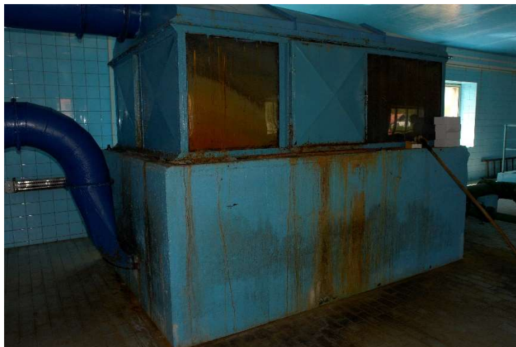
Obr. 23 Stav provzdušňovacího zařízení
