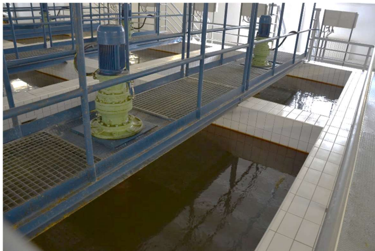
Obr. 25 Vločkovací nádrže – pohon míchadel (únik provozních kapalin s možností přímé kontaminace vody)
