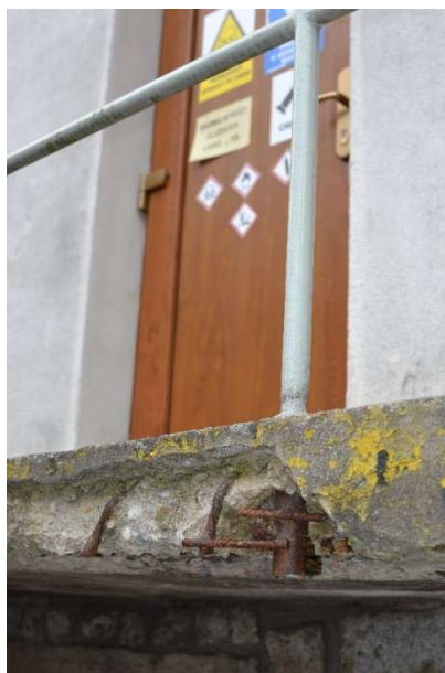
Obr. 30 Narušená konstrukce venkovní rampy – k faktorů ST1.5
