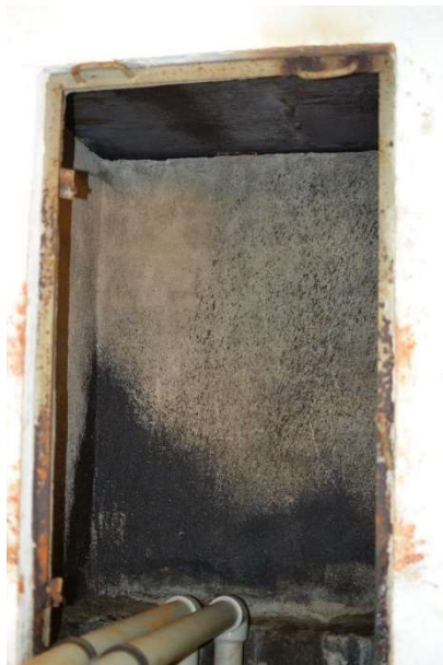
Obr. 33 Chybějící dveře do akumulční nádrže – k faktoru ST1.4
