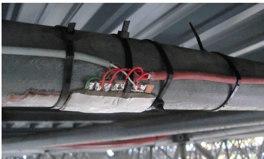
Obr. 73 Odporový tenzometr osazený na horním pásu překrytý ochranou fólií ABM 75 s kabely ke druhému tenzometru (šedý) a k měřicí ústředně (červený).
