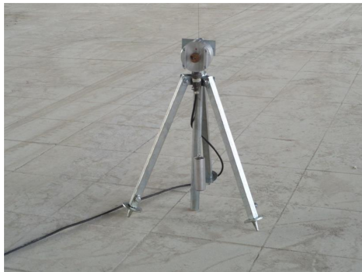
Obr. 88 Potenciometrický snímač deformace instalovaný na podlaze pavilonu D.
