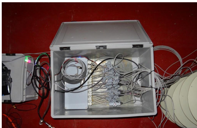
Obr. 134 Měřicí ústředna EMS DV 803 se záložním zdrojem a kabeláží.
