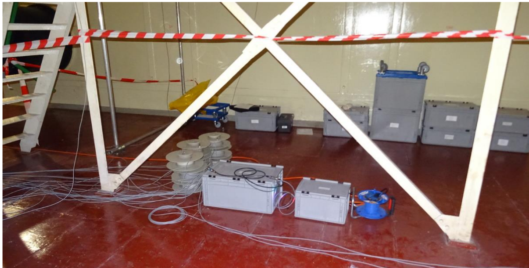
Obr. 146 Pohled na vymezený dočasný sklad v horním plynojemu s měřicí ústřednou a záložním zdrojem po dokončení instalace celého systému.
