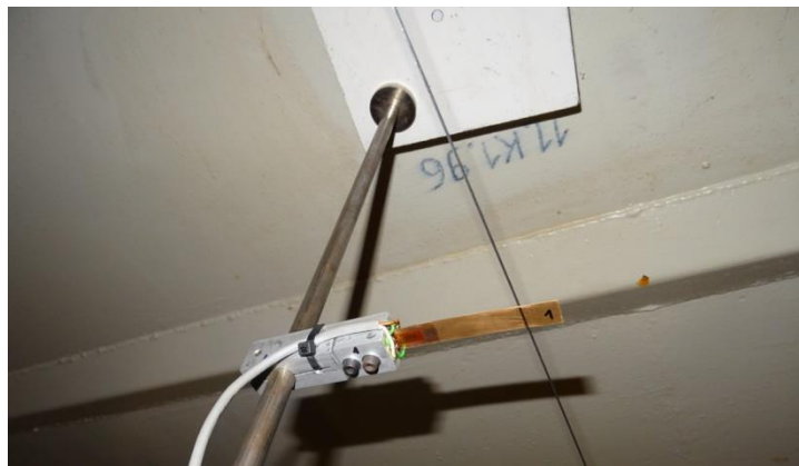
Obr. 140 Nainstalovaný snímač měřicího bodu L1.
