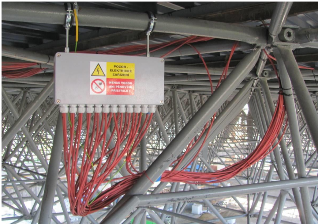
Obr. 82 Jedna ze dvou měřících ústředem EMS DV 803 osazená v konstrukci zastřešení s kabeláží k jednotlivým čidlům.
