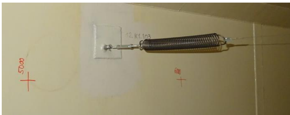
Obr. 120 Pružina T2540 napínající podélné lanko v horním plynojemu zakotvená do pevného bodu.
