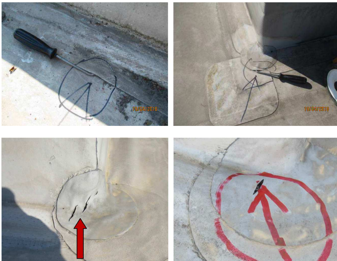
Obrázek 21: Lokalizované netěsnosti ve stávající hydroizolaci (archív autora, společnosti ROMEX s.r.o.)
