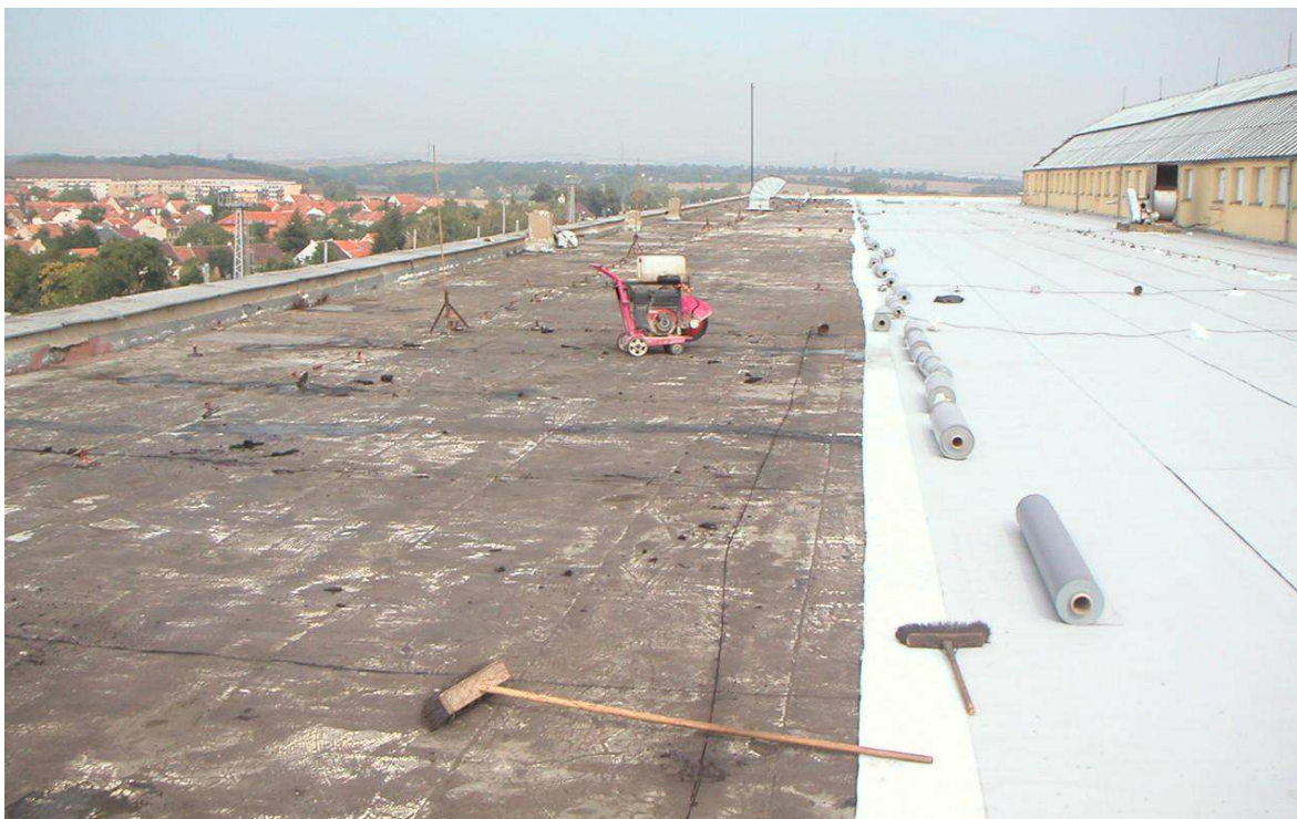
Obrázek 3: Oprava hydroizolační vrstvy ploché střechy plnoplošným provedením nové hydroizolační vrstvy (zdroj : archív autora )
