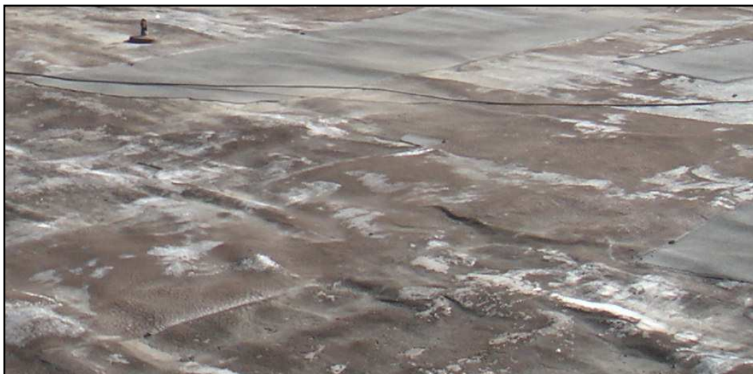
Obrázek 13: Pohled na střešní plášť s vrásněním (zdroj : archiv autora)
