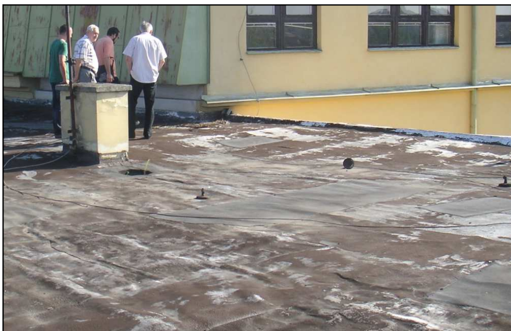
Obrázek 15: Pohled na hydroizolační souvrství s boulemi, největší boule již odstraněny a záplatovány (archív autora)
