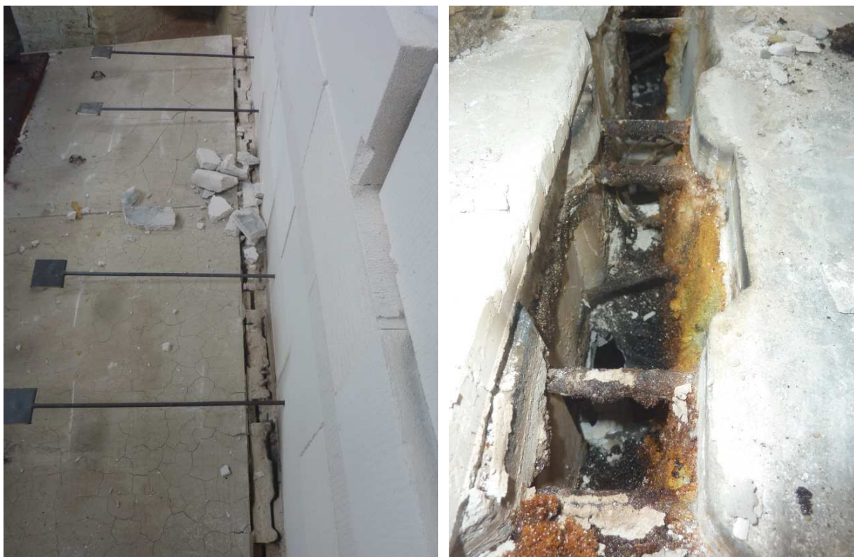
obr. 93: Vzorky den po zkoušce: vlevo spára bez vnějšího zásahu; vpravo po odstranění izolace
