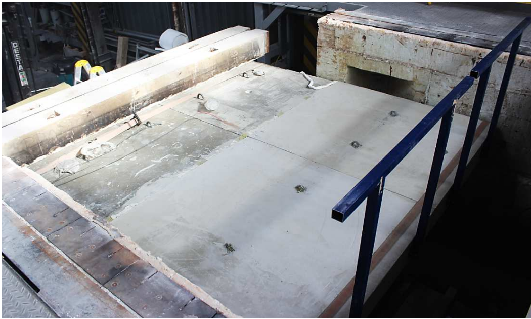
obr. 90: Osazení vzorků v peci – průběh instalace
