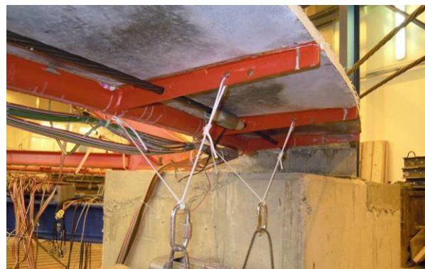
Obr. 7.118 Magenetoelastický snímač na kabelu mostovky
