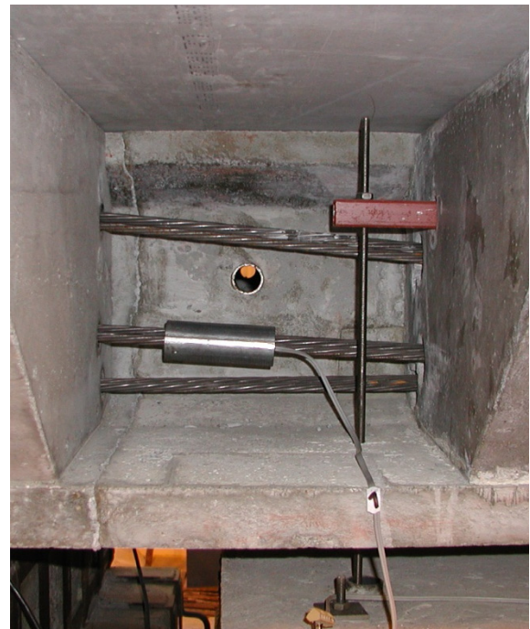
Obr. 6.9 ME snímač na vnějším kabelu
