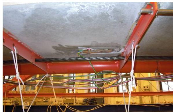
Obr. 7.116 Odporové tenzometry na betonové desce mostovky
