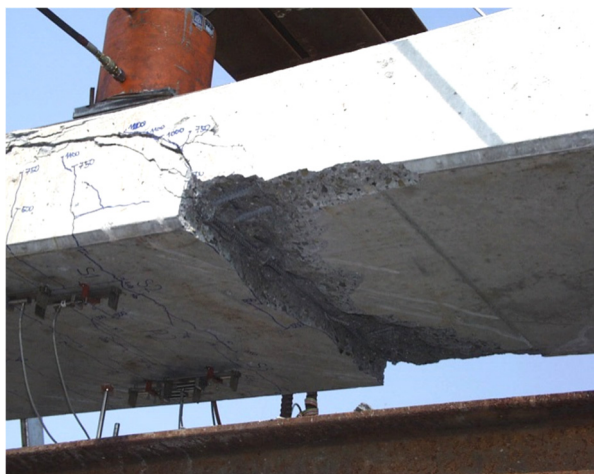
Obr. 8.9 Porušení segmentu mostovky uprostřed rozpětí
