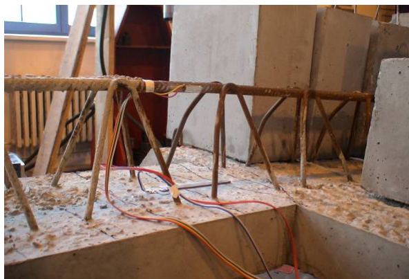
Obr. 8.32 Vybočení diagonál výztuže při mezní únosnosti nad podporou panelu
