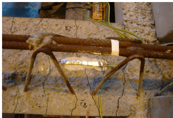
Obr. 8.33 Rozvoj trhlin v nadpodporové oblasti panelu
