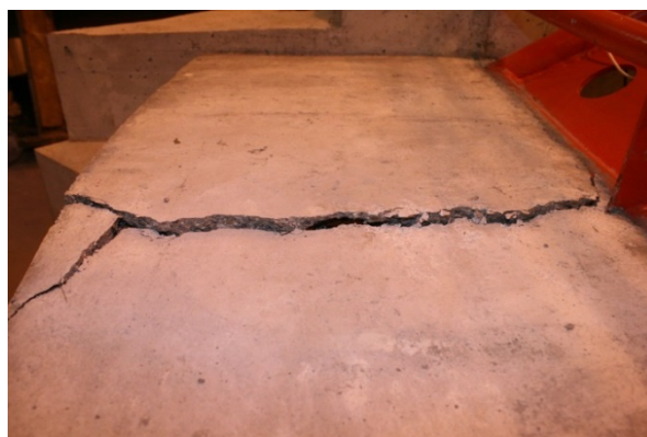
Obr. 7.156 Trhlina, koncový příčnicík
