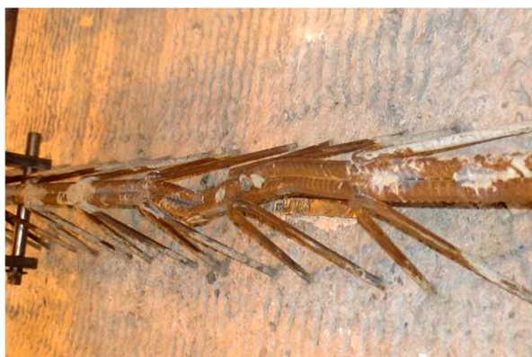
Obr. 8.30 Vybočení tlačného pásu výztuže
