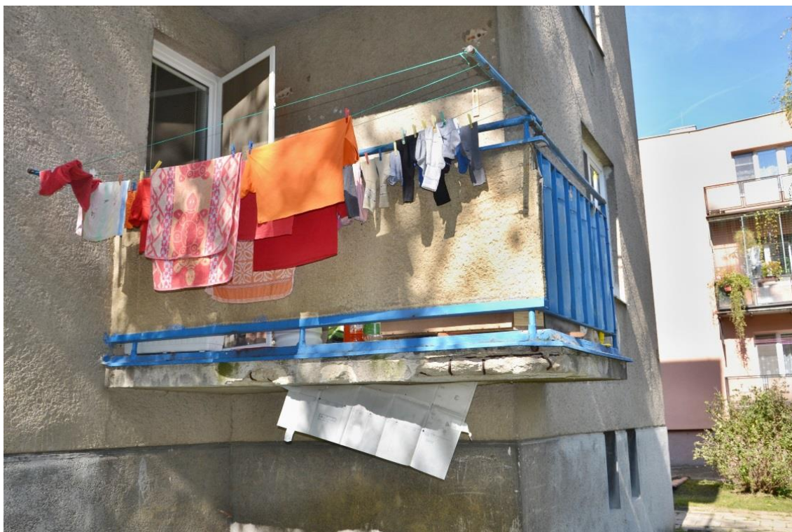
Obr. 107 Balkon v 1.NP na východní straně domu. Jedná se o nejvíce poškozený balkon ze všech, jehož nosná konstrukce vykazuje i značný průhyb
