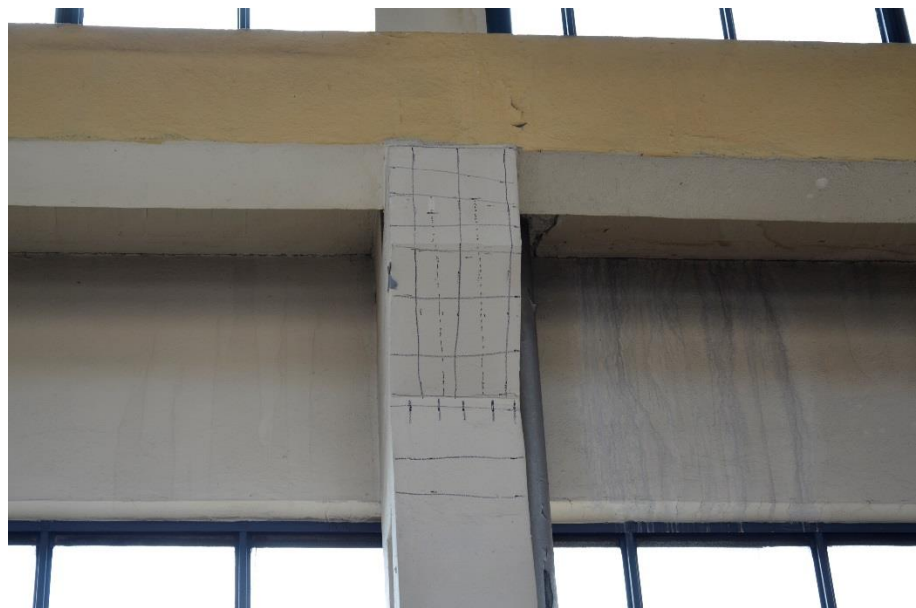
Obr. 153 Liniové měření elektromagnetickým indikátorem na spodním líci nosníku, v blízkosti sloupu S2. V místě provedení sondy N1-3 bylo identifikováno 5 výztuží o průměru 20 mm. Pro další využití byla poloha výztuží současně kreslena na povrch konstrukce [72]
