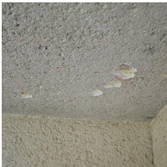
Obr. 117 Sekané sondy k výztuži na spodním líci balkonu v 1.NP
