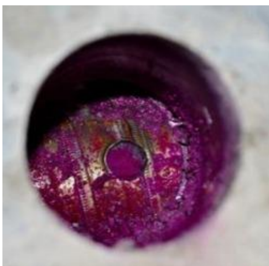
Obr. 35 Předpjatý mostní nosník, příklad návrtu k ocelové chráničce Sandrik, vylomení vývrtu a průraz chráničky až ke kabelu plus provedení fenolftaleinového testu. Současná běžná praxe kontroly zainjektování a stavu předpínací výztuže [27]
