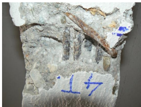
Obr. 22 Příklad rozsáhlé sekané sondy na trámu, pro určení výztuží ve druhé vrstvě by musela být sonda podstatně rozsáhlejší
