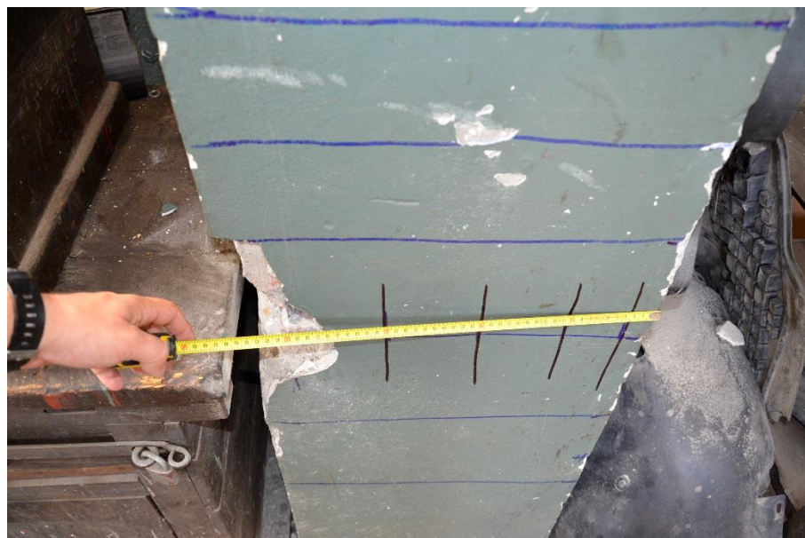
Obr. 144 Liniové měření elektromagnetickým indikátorem napříč sloupem S2 ve výšce 1000 mm od podlahy, v místě provedení sondy S1-2. S využitím kalibrace přístroje bylo zaměřeno celkem 5 profilů hlavní svislé výztuže o průměru 20 mm. Vnitřní hrana sloupu. Pro další využití byla poloha výztuží současně kreslena na povrch konstrukce [72]
