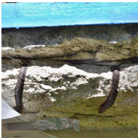
Obr. 108 Detail poškození balkonu v 1.NP. Hlavní výztuž \varnothing 12 (V) je zakončena háky, které jsou obnažené a zkorodované
