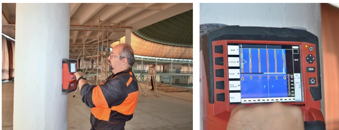
Obr. 53 Měření hlavní výztuže na sloupech nesoucích galerii ve 2. NP Pavilonu Z na Brněnském výstavišti bylo prováděno s mírným pozvednutím čelní části sondy, sonda i v tomto režimu poskytuje relevantní zobrazení polohy hlavních výztuží
