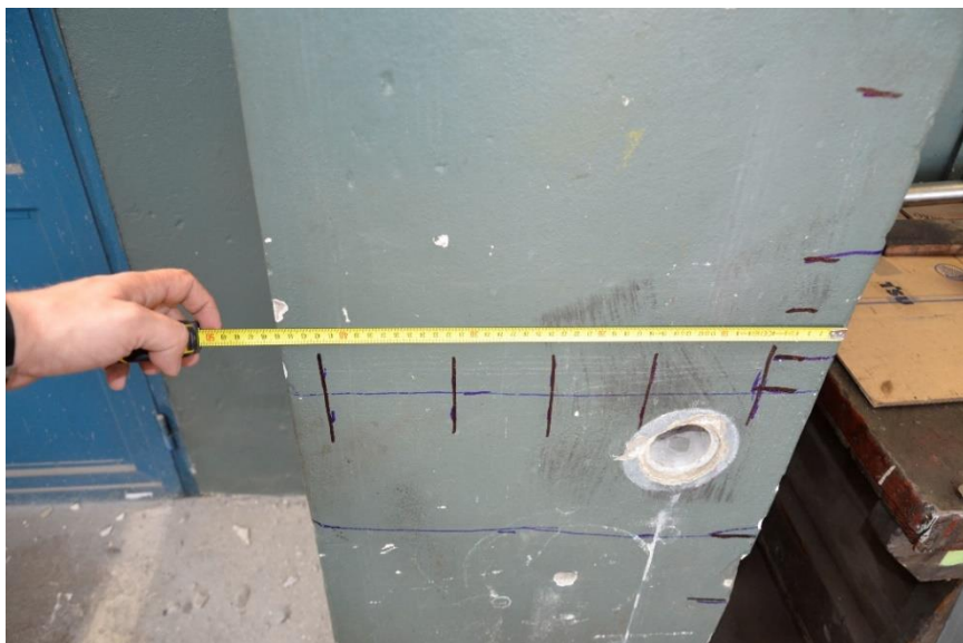
Obr. 135 Liniové měření elektromagnetickým indikátorem napříč sloupem S1 ve výšce 1300 mm od podlahy, v místě provedení sondy S1-1. S využitím kalibrace přístroje bylo zaměřeno celkem 5 profilů hlavní svíslé výztuže o průměru 20 mm. Vnitřní hrana sloupu. Pro další využití byla poloha výztuží současně kreslena na povrch konstrukce [72]
