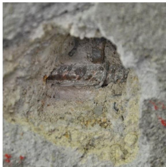
Obr. 118 Detail cílené sondy k výztuži pro ověření průměru a zejména druhu výztužné vložky
