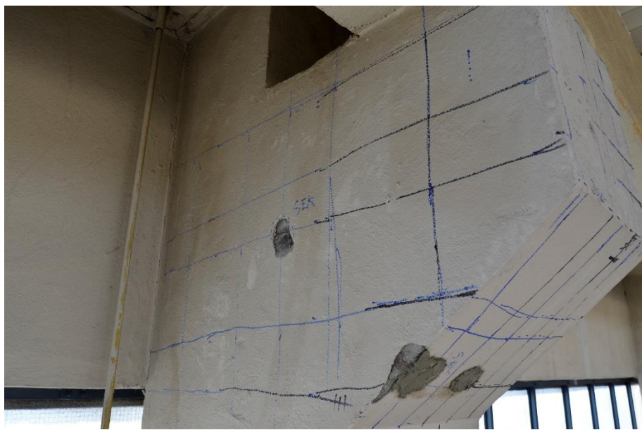
Obr. 141 Liniové měření elektromagnetickým indikátorem napříč konzolou sloupu S1, v místě provedení sondy K1-1b. S využitím kalibrace přístroje Profometer PM630 bylo zaměřeno celkem 8 profilů svislé výztuže o průměru 20, 18 a 8 mm. Vodorovná výztuž byla ověřena sekanou sondou označenou SV4. Pro další využití byla poloha výztuží současně kreslena na povrch konstrukce [72]
