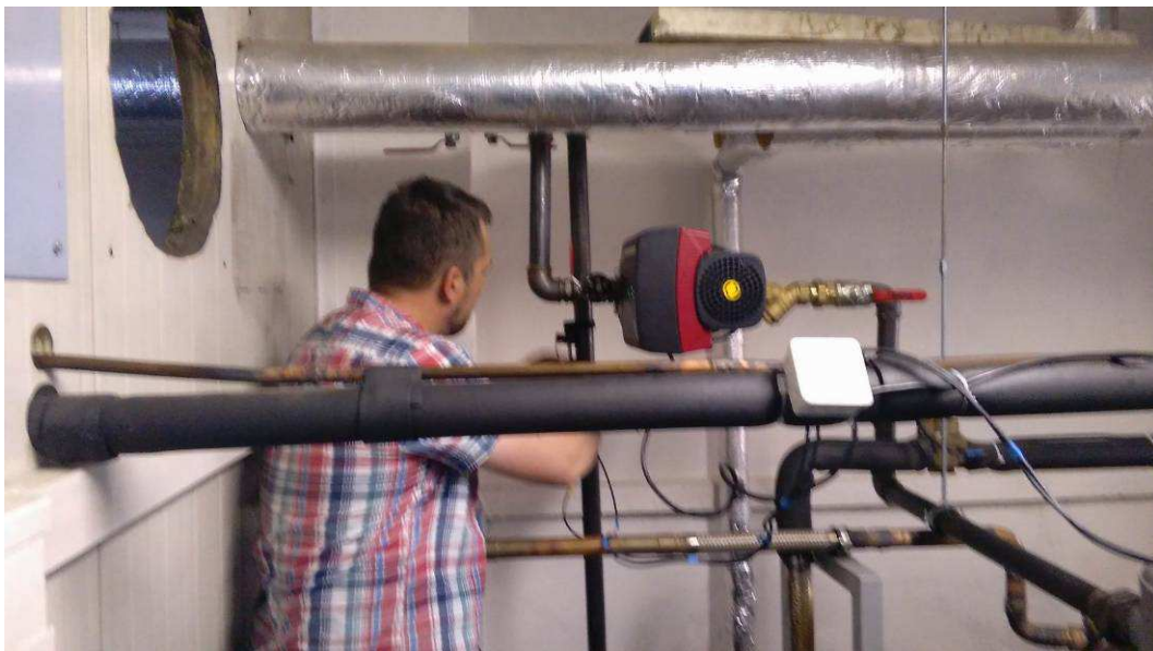
Obr. 5.22 Měření průtoku vody na potrubí pro využití odpadního tepla z motoru a spalín
