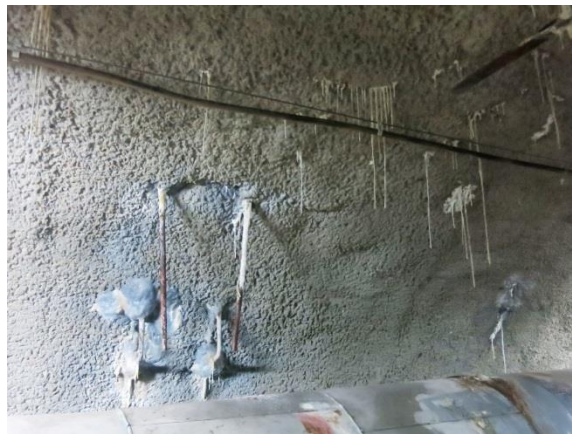
Obr. 3.47 Síť trhlin s výluhy, lokální sanace kolem ocelových konzol, (Lacina, 2014)
