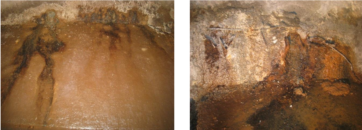
Obr. 3.46 Výtok rezavého bahna a degradace betonu v blízkosti pracovních spár (vlevo) a v čelbě (vpravo), (snímky poskytnuty spoluřešitelem Amberg Engineering)
