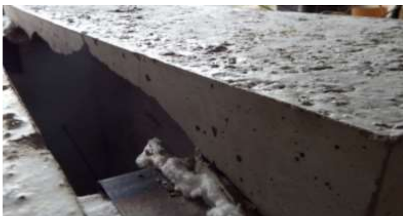
Obr. 10-19 Odprýsknutí betonu na spodní zahřívání straně desky, beton R7-OL-I (cement CEM I 42,5 R Mokrý, kamenivo biotický granodiorit)
