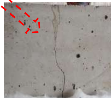
Obr. 10-20 Trhlina před celou tloušťku desky, beton R7-OL-I (cement CEM I 42,5 R, kamenivo biotický granodiorit)
