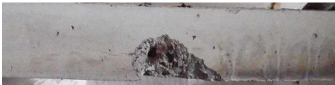
Obr. 10-17 Vzhled betonu R2-BL-F (CEM I 42,5 R, 1kg/m 3 PP, kamenivo čedič Bílčice) po zatížení na 850 °C, odprýsknutí betonu na boku desky
