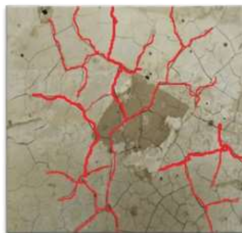
Obr. 10-8 Beton R1-BL-I (CEM I 42,5R, kamenivo čedič Bílčice) po zatížení na 850 °C, trhliny na povrchu vzorku jsou zvýrazněné červeně
