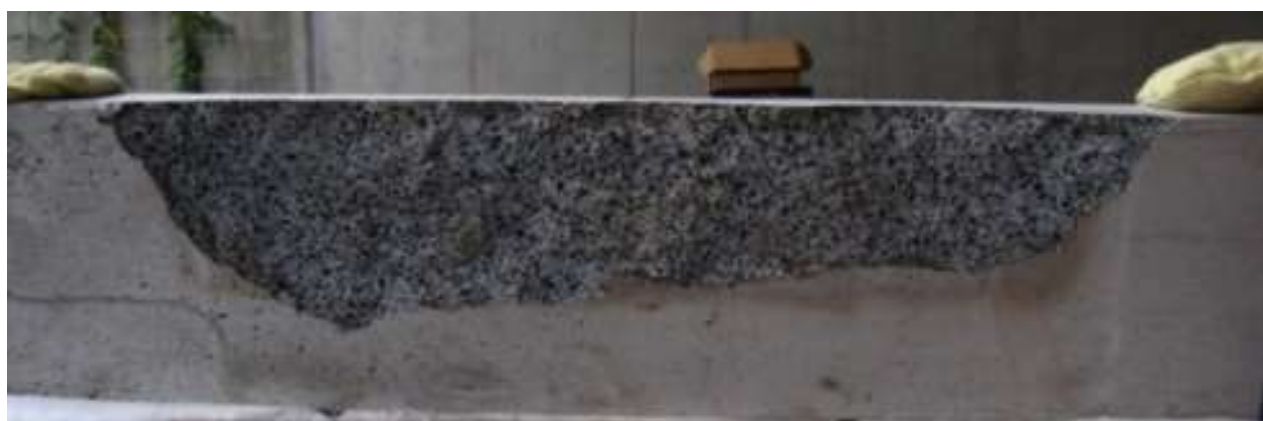
Obr. 10-24 Vzhled desky z betonu L-II (cement CEM II/B-S 32,5 R Prachovice, lehké kamenivo Liapor) po zatížení na 850 °C. Detail odprýsknutí betonu na zahříváné straně desky. Viditelná deformace desky – průhyb desky.
