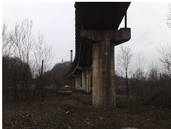
Obr. 76 - Most Gagarin před rekonstrukcí – pohled zespedu
