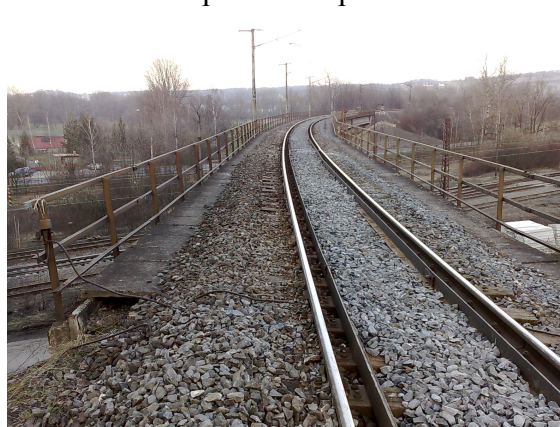
Obr. 78 - Most Gagarin před rekonstrukcí – pohled na kolej
