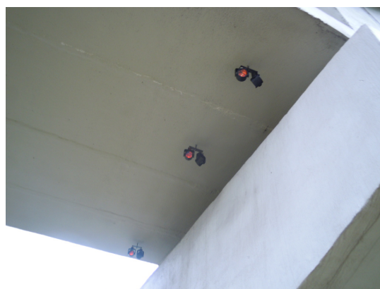
Obr. 101 – Detail odrazných hranolů pro geodetický monitoring
