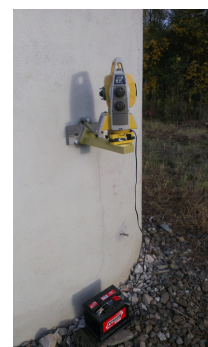
Obr. 104 – umístění stanice na podpoře
