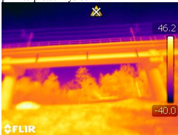
Obr. 144 – Termovizní snímek jižní strany pole 2 (28.9.2014 13:30h)
