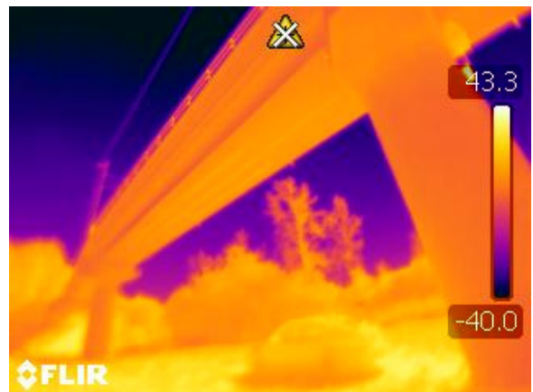
Obr. 145 – Termovizní snímek severní strany pole 2 (28.9.2014 13:30h)
