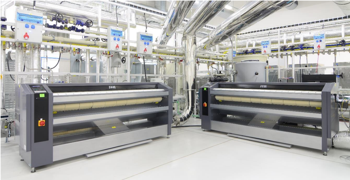
Obr. P4.2 Válcové žehliče, které jsou součástí modelu průmyslové prádelny v Laboratoři energeticky náročných procesů, NETME Centre
