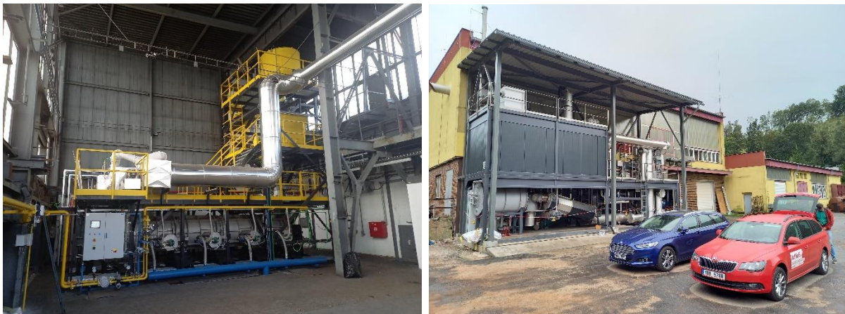
Obr. 14 Průmyslové instalace středněteplotní pyrolýzy ČK v ČR (vlevo areál teplárny ve Zlíně – Malenovicích TP3, vpravo ČOV Trutnov – Bohuslavice TP2)
