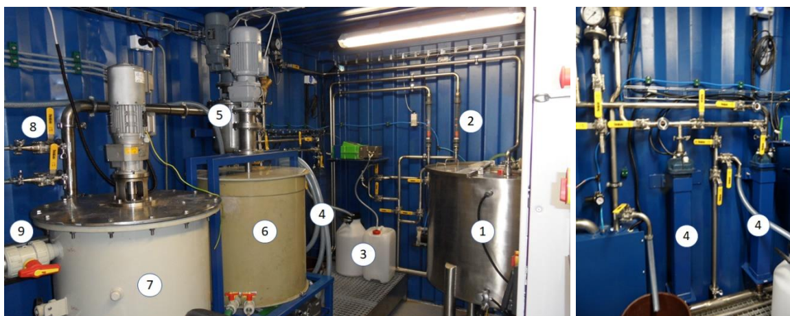
Obr. 22 Pohled na vnitřní součásti kontejneru. 1) zásobní nádrž, 2) průtokoměry, 3) zásobníky regeneračních roztoků, 4) elektrokoagulační cely (na obr. Vlevo schované za hadicemi), 5) rychle míchaná nádrž, 6) zásobník flokulantu, 7) pomalu míchaná nádrž, 8) vzorkovací ventily, 9) přepad do usazovací nádrže (dle komentovaných položek 12 a 13). Vlastní foto.
