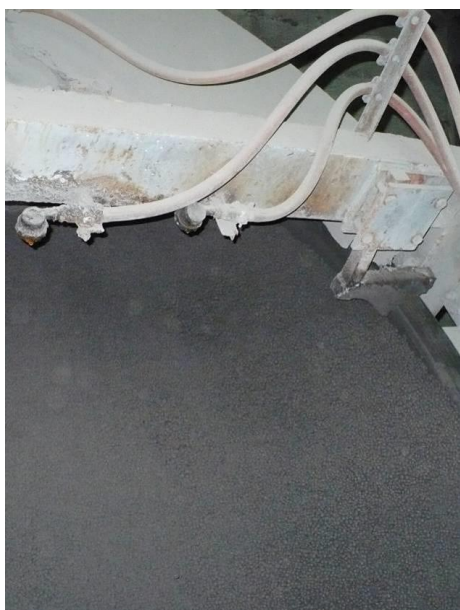
c) Pohled na přívod vody
