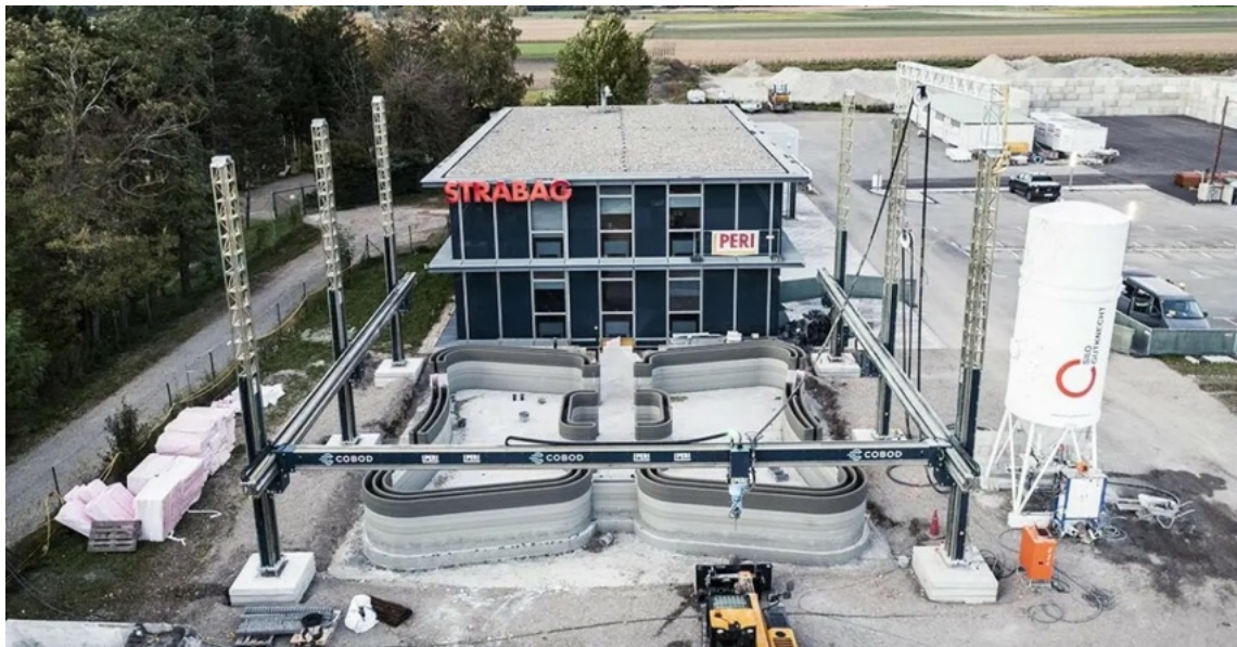
Obr. 29) Tisk budovy pomocí rámové tiskárny COBOD BOD2. Byla zvolena realizace pomocí tří perimetrů tisku (zdroj: https://www.strabag.com ).
