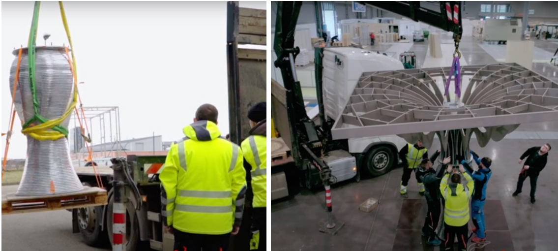
Obr. 68 a 69) Vlevo auto transport kompletního prvku 3D tištěného kmene s osazenými ocelovými přírubami. Vpravo kompletace stromu TAPIRUS, osazení dřevěné koruny (zdroj: autor).
