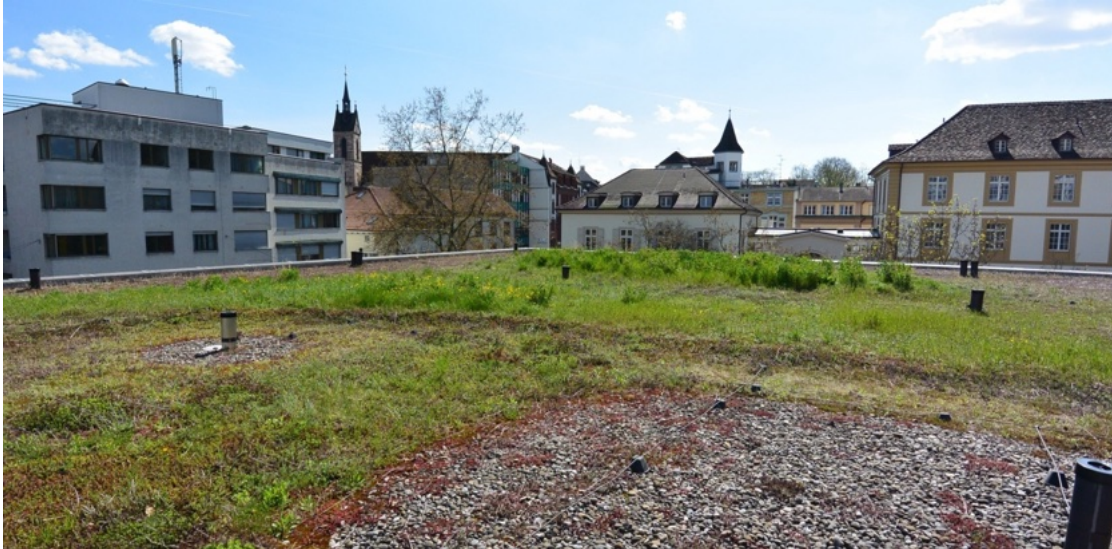
Obr. 15) Biodiverzní střecha objektu budovy Klinikum II v Basileji, Švýcarsko (zdroj: Selník, P., 2015)
