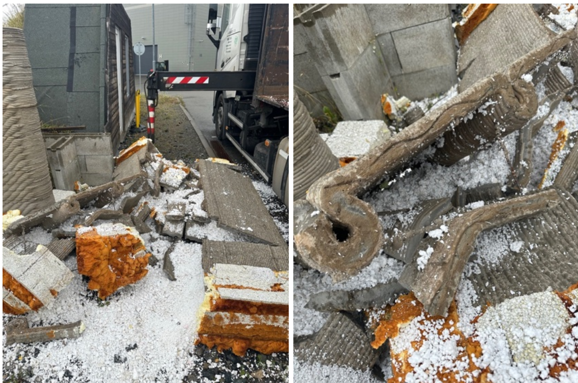
Obr.80 a 81) Pohled na havárii stěny, která byla poškozena během manipulace pro vnitroareálový transport (zdroj: autor)
