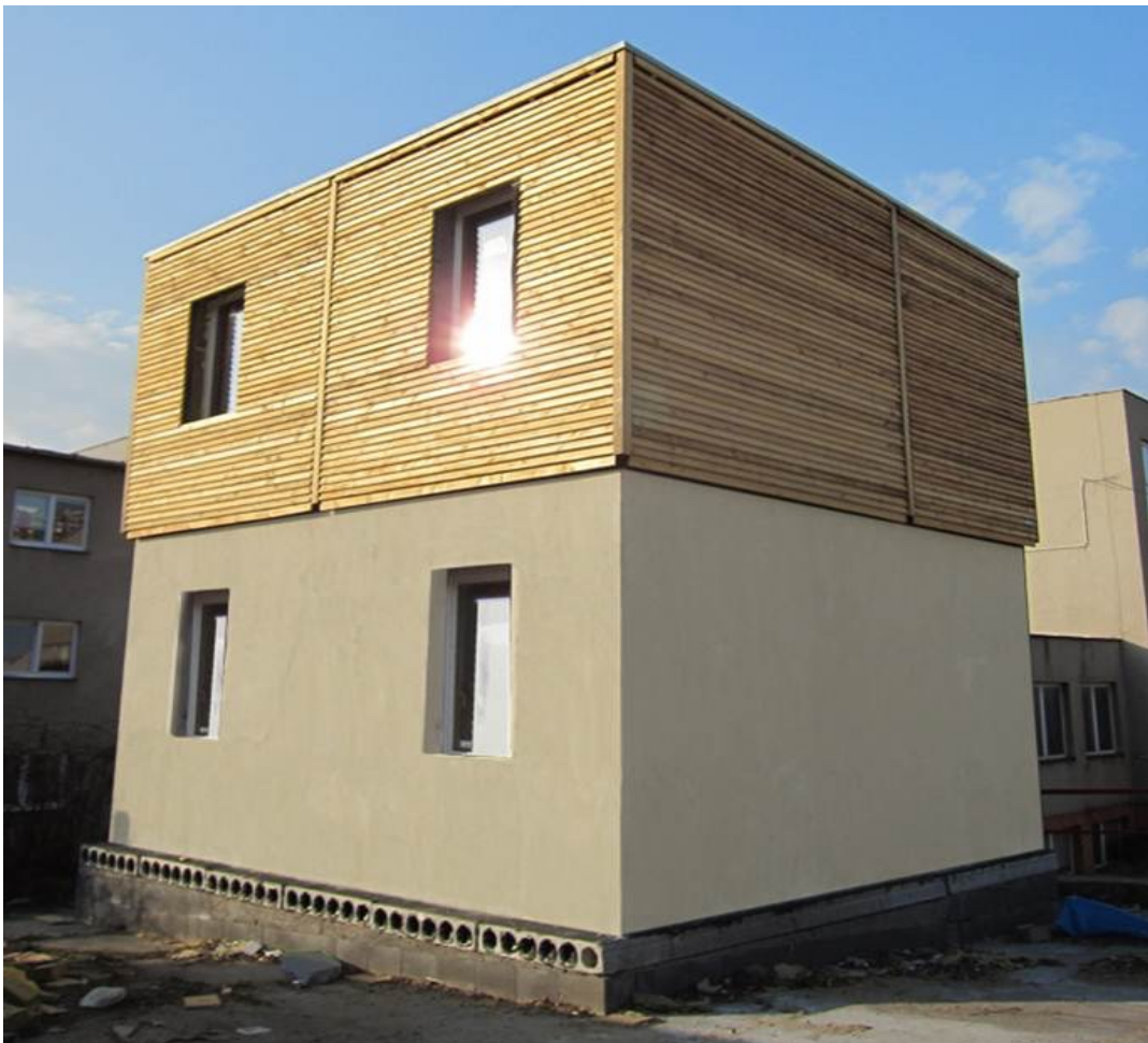
Obr. 35) Experimentální dřevostavba s osazeným systémem monitoringu konstrukcí BRESET (zdroj: autor)
