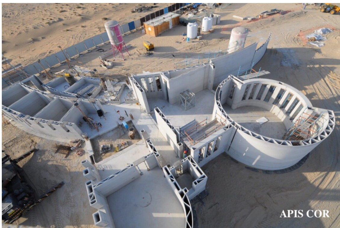
Obr. 28) Reliáze největší budovy vytvořené technologií 3D tisku. Pohled na zdivo 1. podlaží (zdroj: https://www.archdaily.com © Apis cor)
