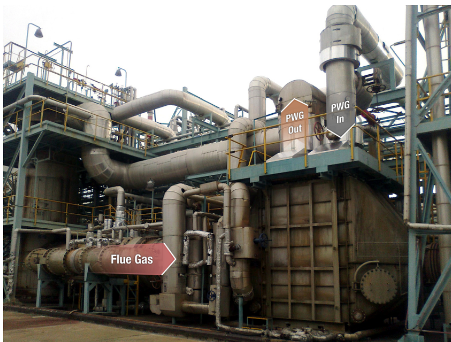
Obrázek 1.2. Předehřívák procesního odplyn; odplyn („Process Waste Gas“, PWG) vstupuje do výměníku v horní části a po průchodu U-trubkovým svazkem odchází do spalovací pece (na fotografii úplně vlevo), spaliny („Flue Gas“) z pece prochází výměníkem horizontálně
