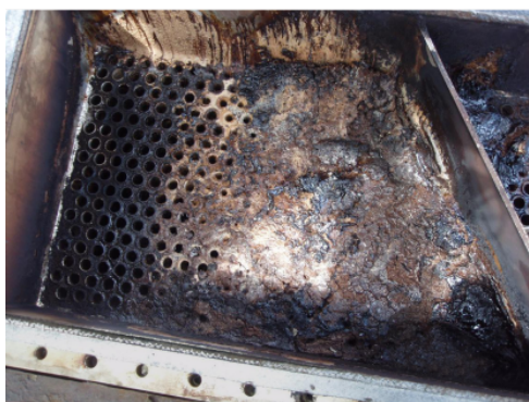
(a) boční část zanesené trubkovnice
