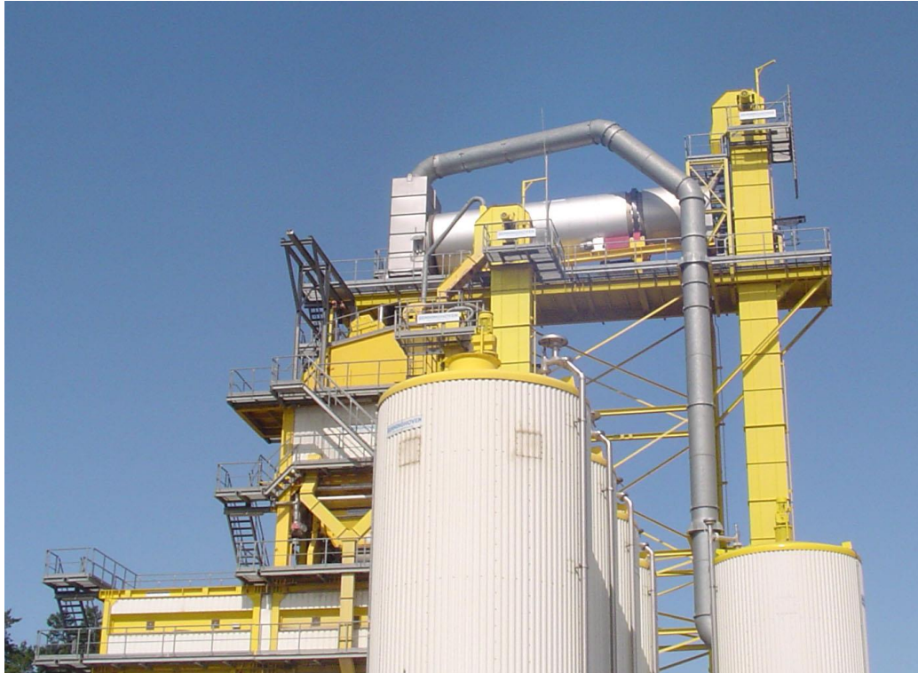
Obrázek 4: Šaržová obalovna s paralelním sušícím bubnem, umístěným v horní části obalovny
