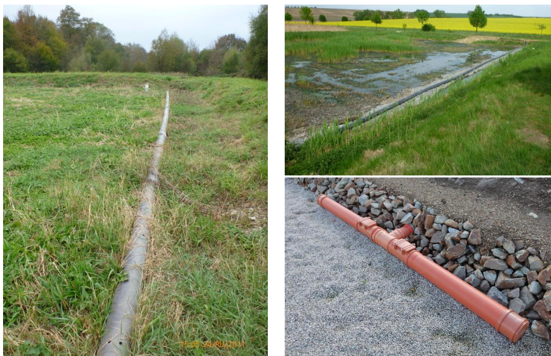
Obr. 37 Přívodní potrubí na HF (Hostětín, Dražovice, Cekov)
