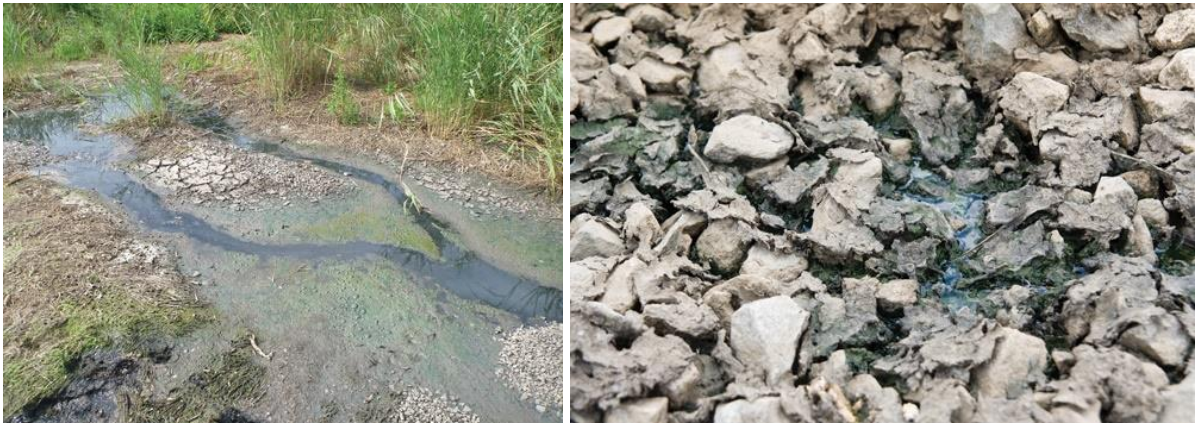
Obr. 2 Projevy kolmatace: povrchové toky a zakolmatovaný filtrační materiál
