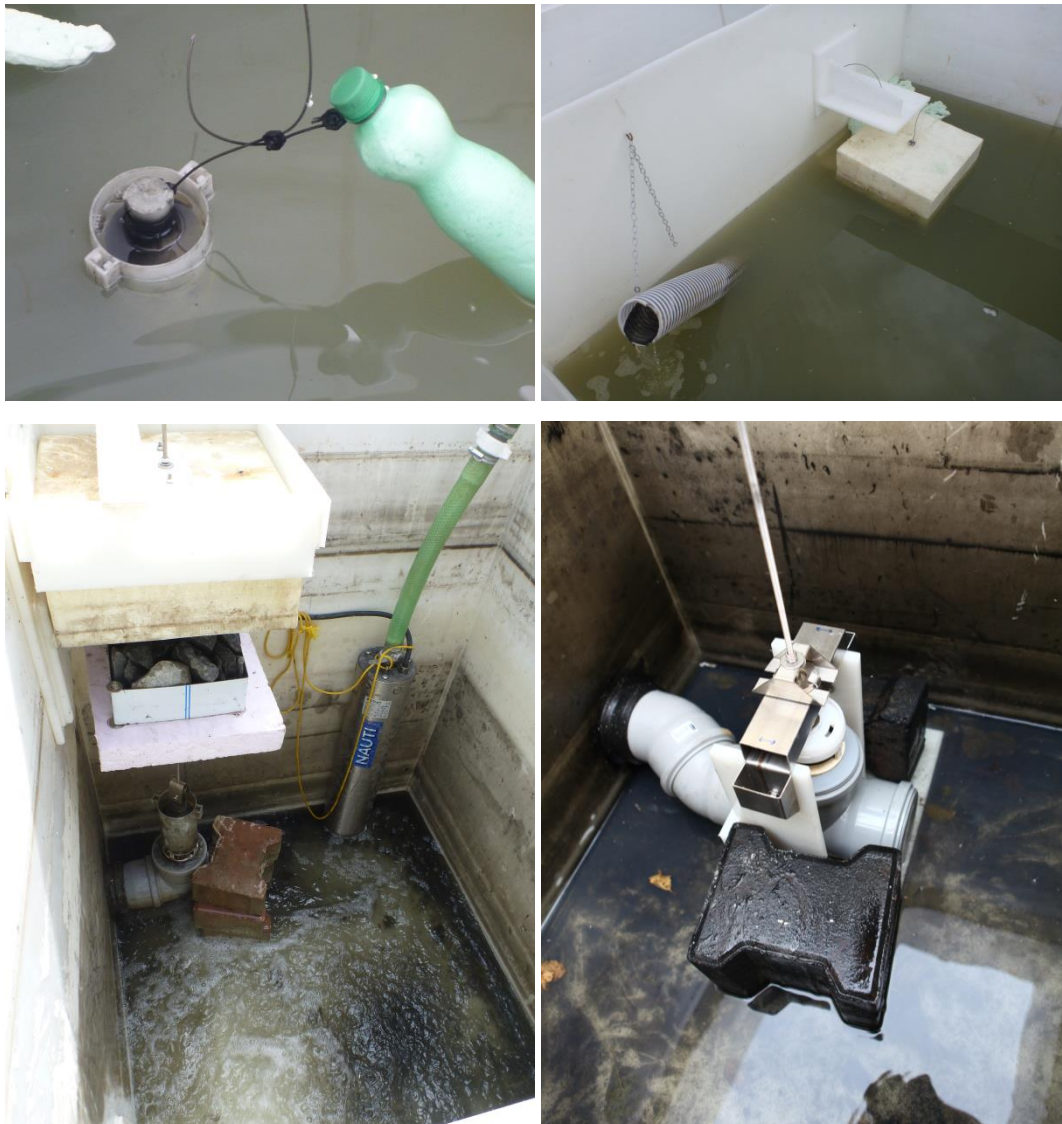
Obr. 47 Postupný vývoj zařízení v rámci poloprovozního objektu na ČOV Kotečnice
