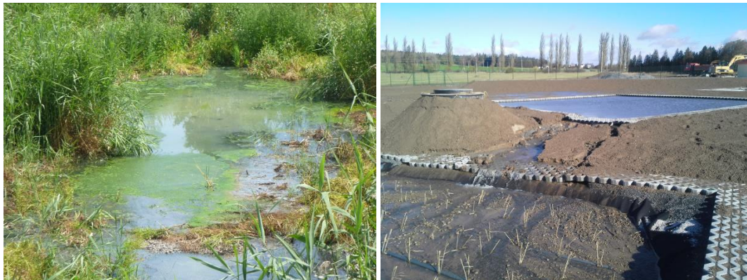
Obr. 7 A) Zakolmatovaný povrch horizontálního filtru B) porucha nového filtru vlivem ucpání
