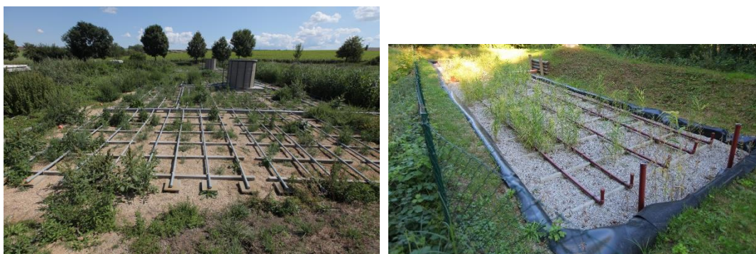
Obr. 46 A) Vertikální filtr s distribučním systémem a B) pohled na VF pro chatářskou oblast
