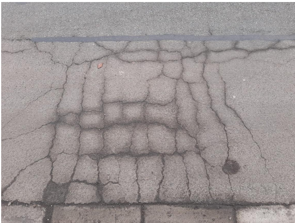
Obrázek 110: Lokální výskyt síťových trhlín na omezené ploše povrchu obrusné vrstvy 2. sekce pokusného úseku I/34 Polička (ulice Hegerova) po šesti letech provozu [146]
