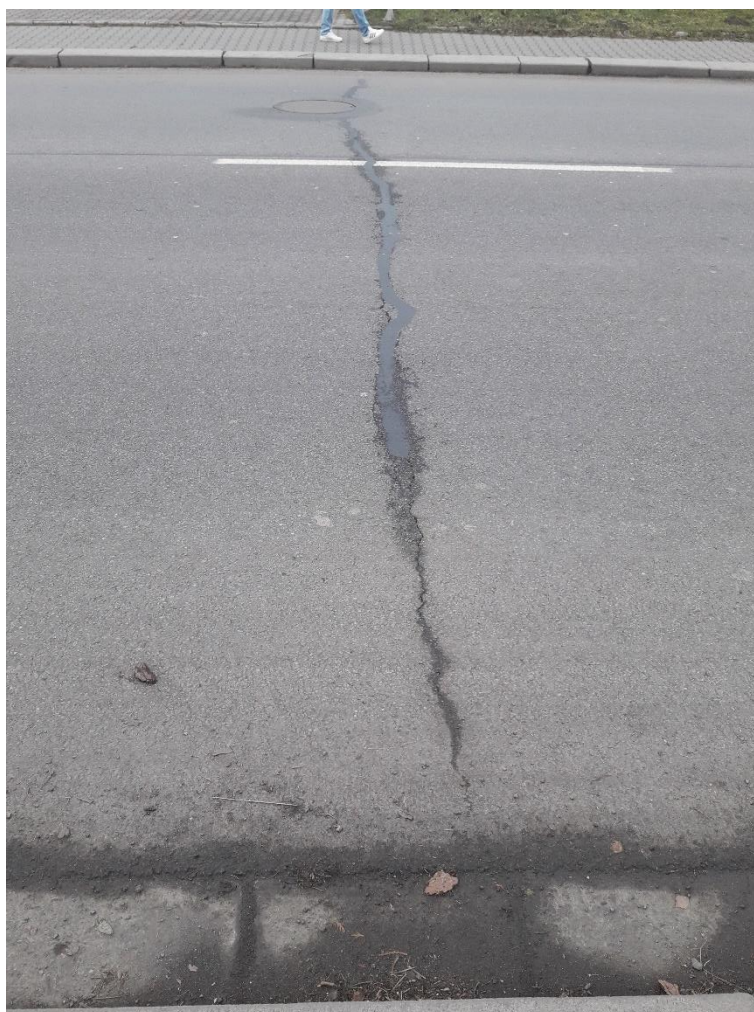
Obrázek 108: Mrazová trhlina na povrchu obrusné vrstvy 1. sekce pokusného úseku I/34 Polička (ulice Hegerova) po šesti letech provozu [146]
