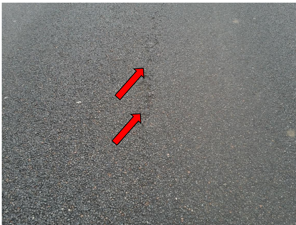
Obrázek 107: Ztráta asfaltového tmelu z povrchu obrusné vrstvy 3. sekce pokusného úseku I/34 Polička (ulice Hegerova) po třech letech provozu [48]
