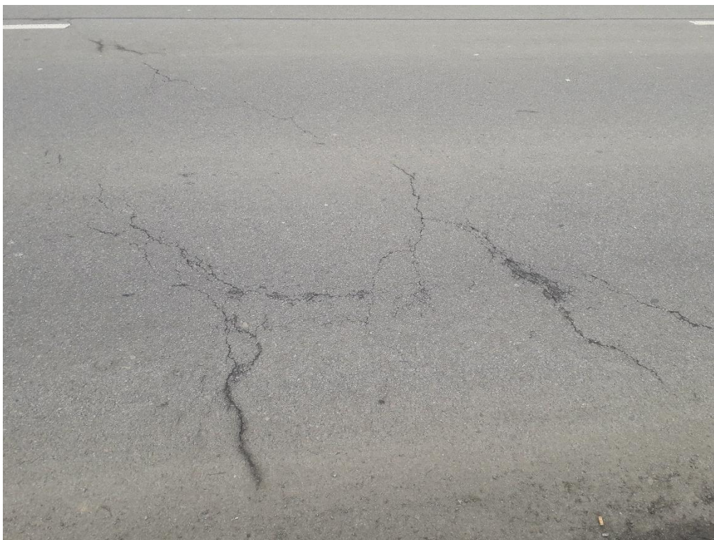
Obrázek 109: Nepravidelné trhliny na povrchu obrusné vrstvy 1. sekce pokusného úseku I/34 Polička (ulice Hegerova) po šesti letech provozu [146]
