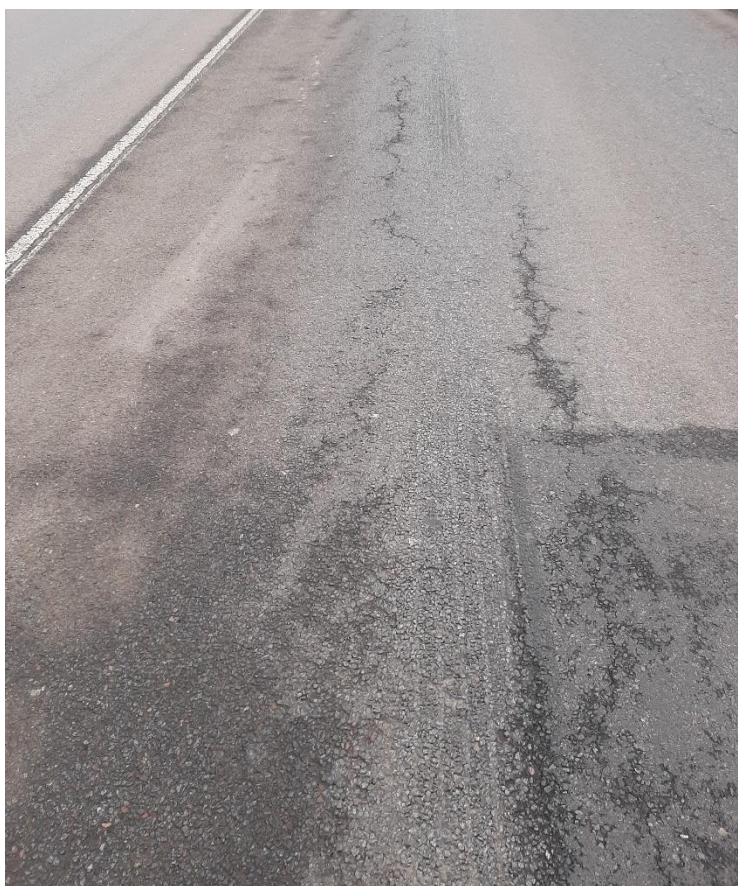
Obrázek 112: Ztráta asfaltového tmelu a hloubková koroze na povrchu obrusné vrstvy 3. sekce pokusného úseku I/34 Políčka (ulice Hegerova) po šesti letech provozu [146]
