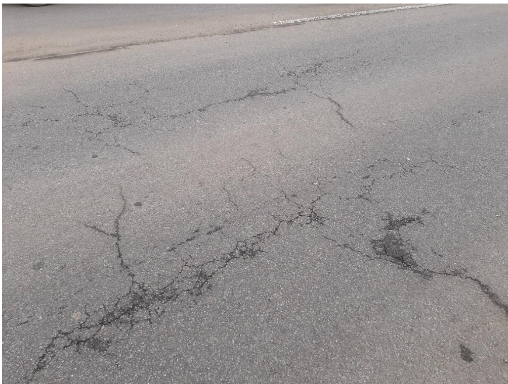
Obrázek 111: Nepravidelné trhliny na povrchu obrusné vrstvy 3. sekce pokusného úseku I/34 Políčka (ulice Hegerova) po šesti letech provozu [146]
