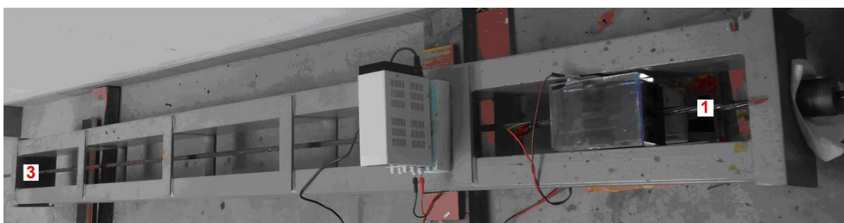
Obr. 5.75. Pohled na předpínací rám s předpjatým lanem s připojeným korozním boxem a označením pozic měření (1, 3).
