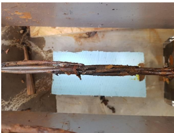
Obr. 5.83. Stav předpjatého lana po pěti stech devadesáti třech hodinách působení korozního procesu.
