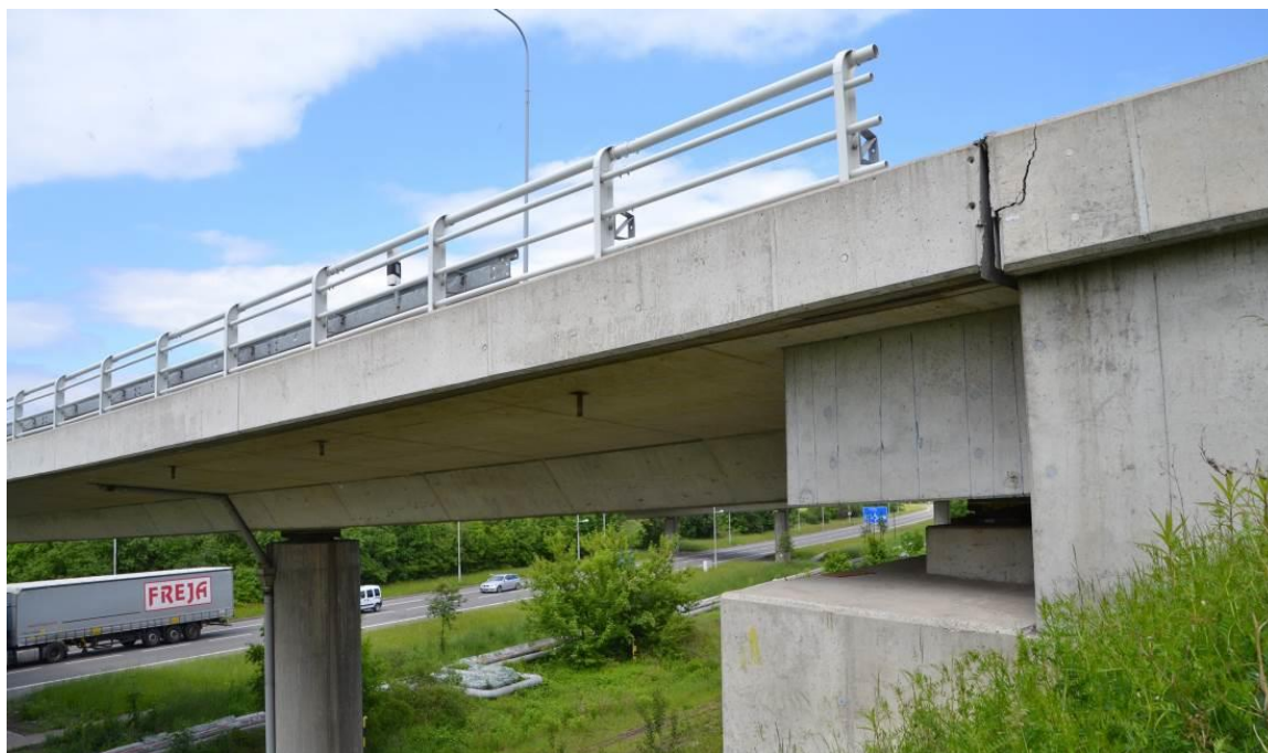
Obr. 91 Pohled na most v Ostravě – Mariánských Horách, nosná konstrukce je zakončena mohutným koncovým příčníkem
