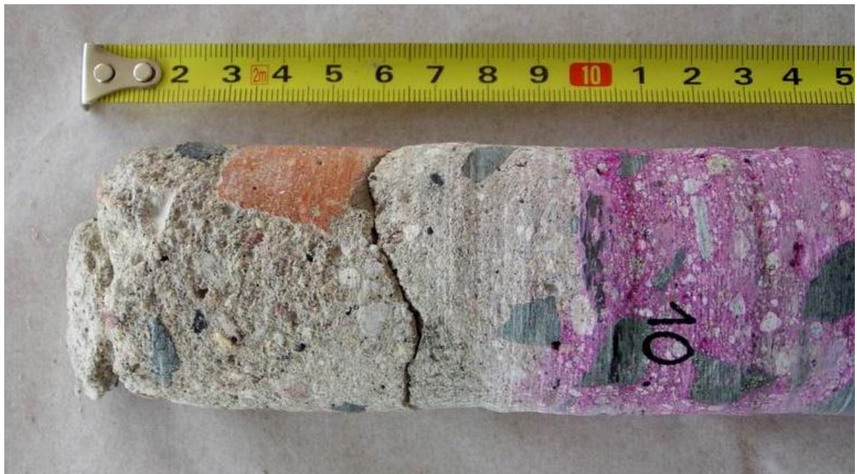
Obr. 28 Dokumentace vývrtu z místa s nejnižší pevností v tlaku z NDT zkoušek – povrch betonu je degradovaný, hloubka karbonatace dosáhla 90 mm
