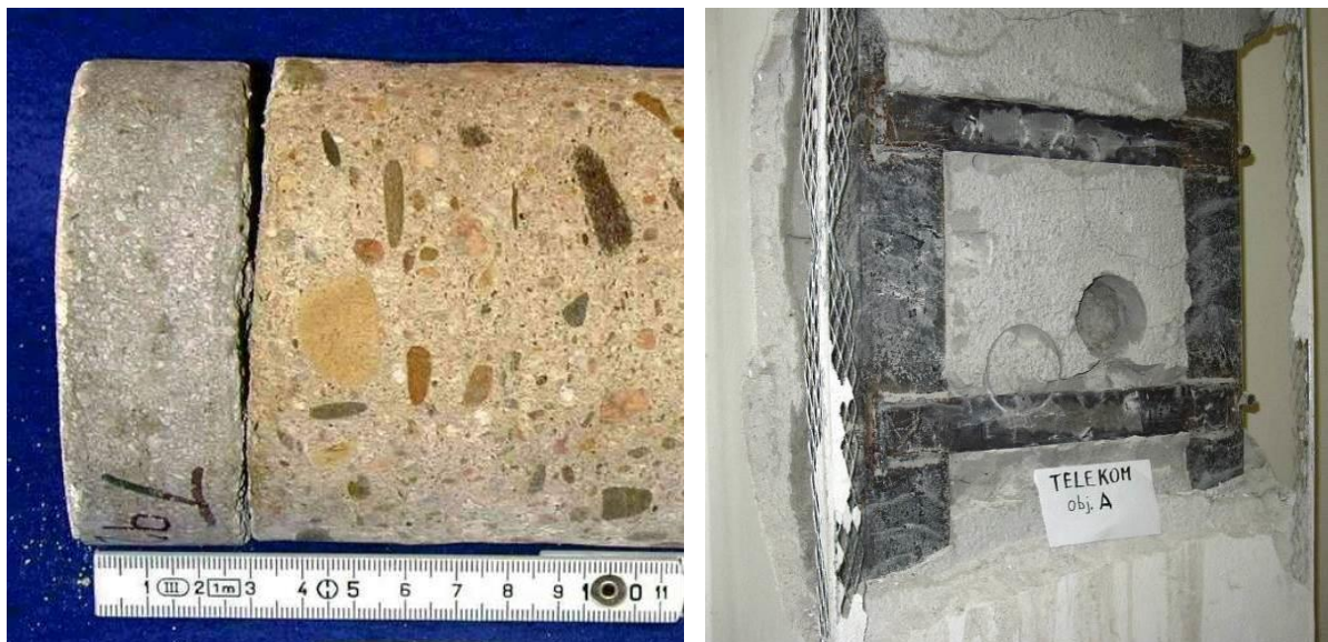
Obr. 31 Vzorek betonu odebraný z nosného sloupu s jemnozrnnou vrstvou na povrchu, což byl torkret provedený v minulosti v rámci statického zajištění sloupů – vpravo fotografie sloupu po obnažení zesílení prostřednictvím ocelové bandáže v rozích
