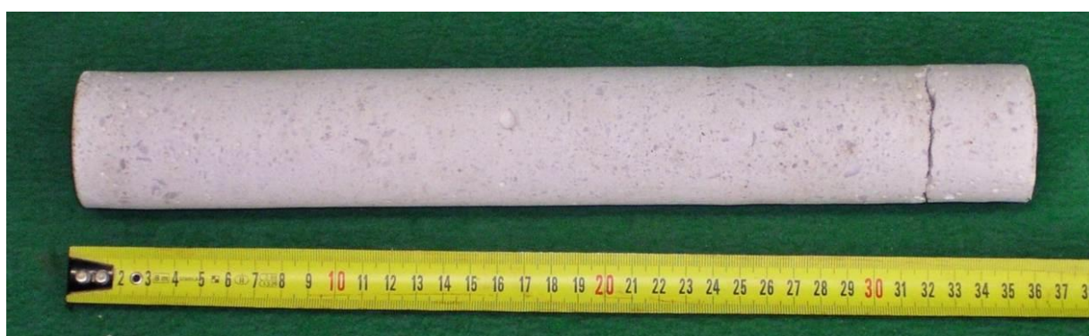
Obr. 115 Vzorek betonu odebraný ze soklu jádrovým vrtáním – jádro bylo kompaktní, trhlinka byla způsobena vylomením jádra před nasazením nástavce vrtáku
