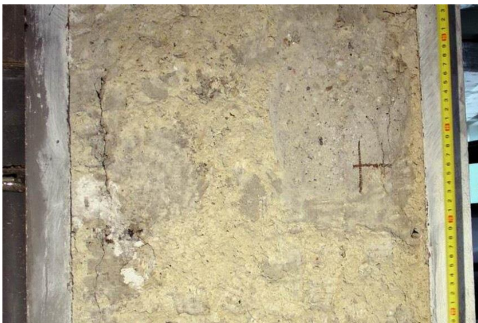
Obr. 72 Svislé trhliny na obou stranách sloupu č. 7 v místě hlavní výztuže, v dolní polovině výšky sloupu
