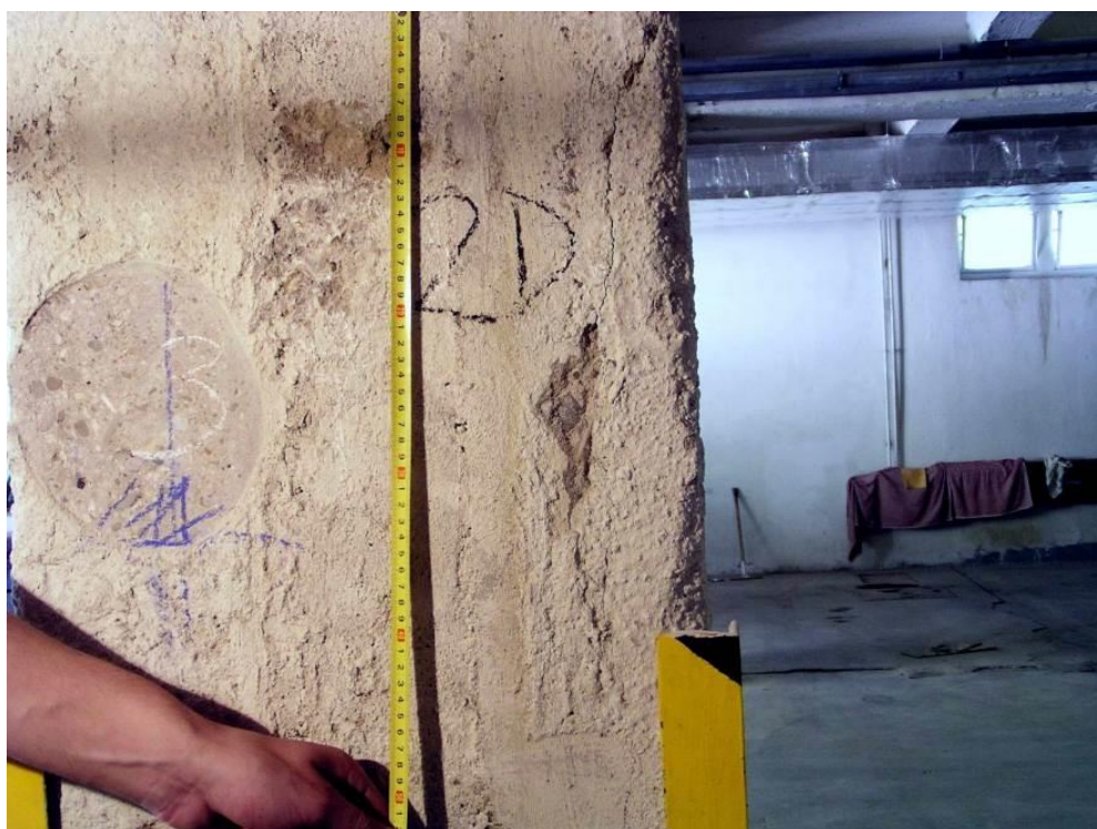
Obr. 70 Svislá trhlina na sloupu č. 2 v místě hlavní výztuže
