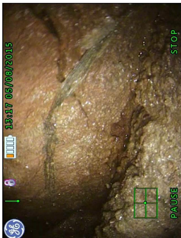
Obr. 131 Detail povrchu jedné z pásovin kotvicích disk do soklu s patrnou hlubší korozi, skutečnou míru poškození však lze jen odhadovat
