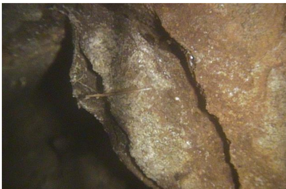
Obr. 130 Detail poškození okraje pásoviny podélnou svislou trhlinou
