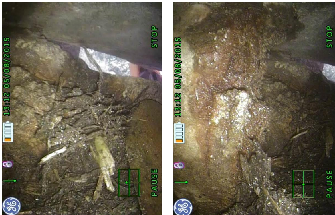
Obr. 129 Pohled videoskopem do nezainjektované kapsy v soklu vyplněné biologickým materiálem, vpravo zkorodovaný povrch výztuhy procházející ze soklu do horního disku
