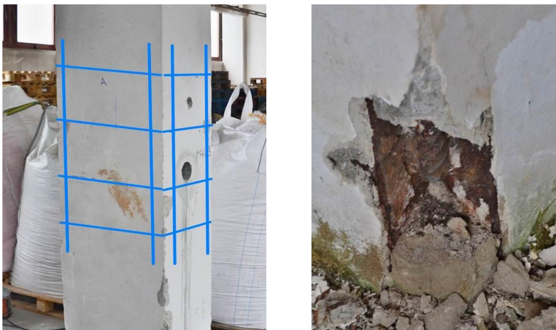
Obr. 104 Prefabrikovaný sloup obdélníkového průřezu s vyznačenou hlavní výztuží (4 pruty v rozích) a třmíneků s dostatečnou vzdáleností od sebe > 200 mm; vpravo kontrola průměru v místě odpadnuté krycí vrstvy – výztuž Ø 28 mm přivařená k úhelníku
