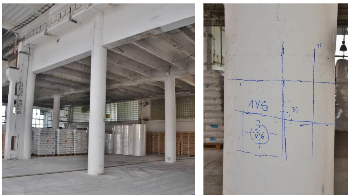
Obr. 106 Monolitický sloup kruhového průřezu o průměru 650 mm s vyznačenou hlavní výztuží a ovíjenými třmínky (se vzdáleností cca 180 mm od sebe)
