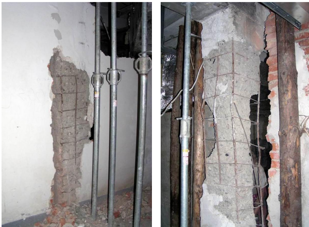
Obr. 69 Vlevo pohled na sloup s odpadnutou krycí vrstvou těsně po kolapsu. Vpravo pohled z druhé strany, vyboulená výztuž viditelná po odstranění nesoudržného betonu
