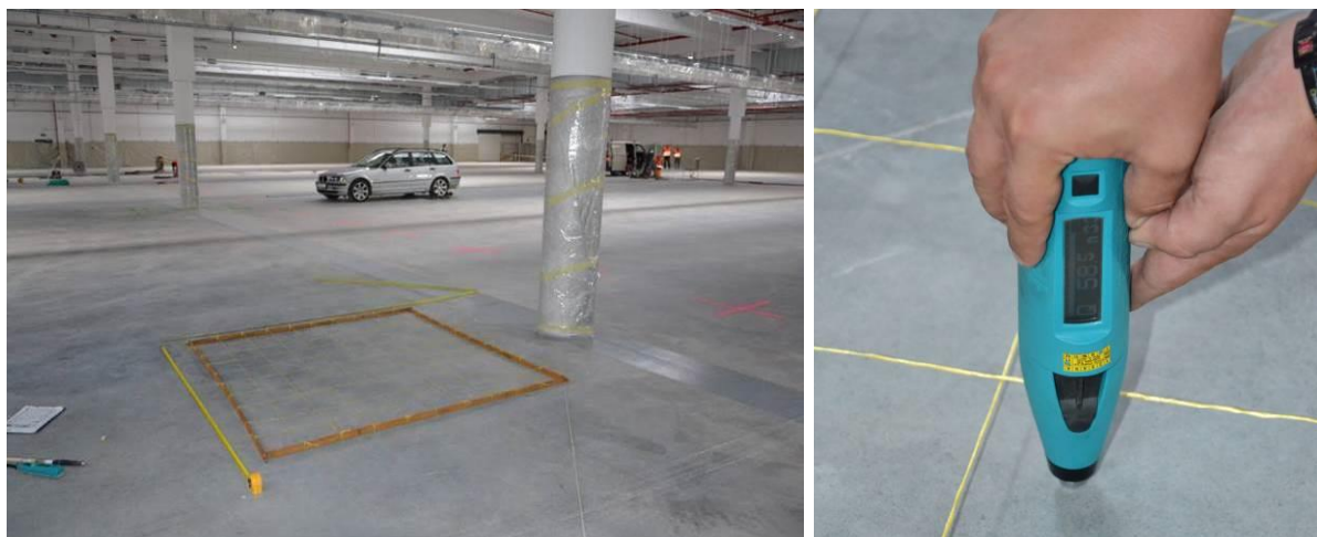
Obr. 42 Průmyslová podlaha z drátkobetonu s vrstvou vsypu – vlevo vytyčení rastru pro měření přístrojem Silver Schmidt PC-N, vpravo detail přístroje při zkoušce
