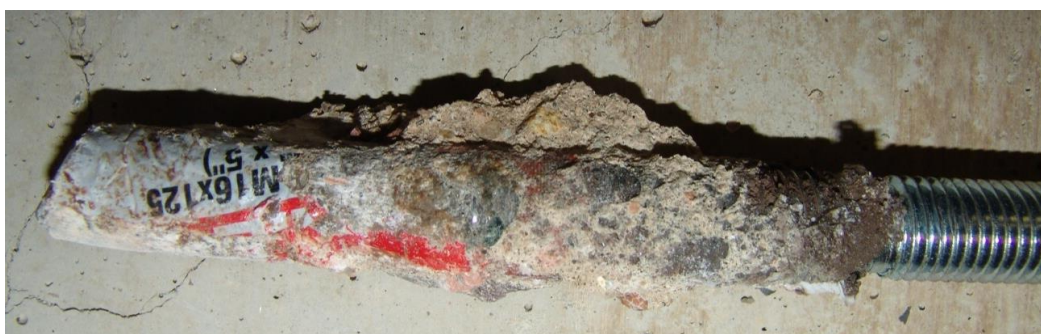
Obr. 1-9 Nedokonale rozrušený obal patrony při instalaci
