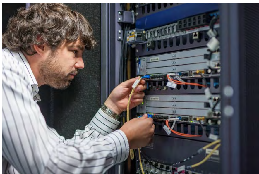
Centrum SIX disponuje vlastní telekomunikační sítí LTE
