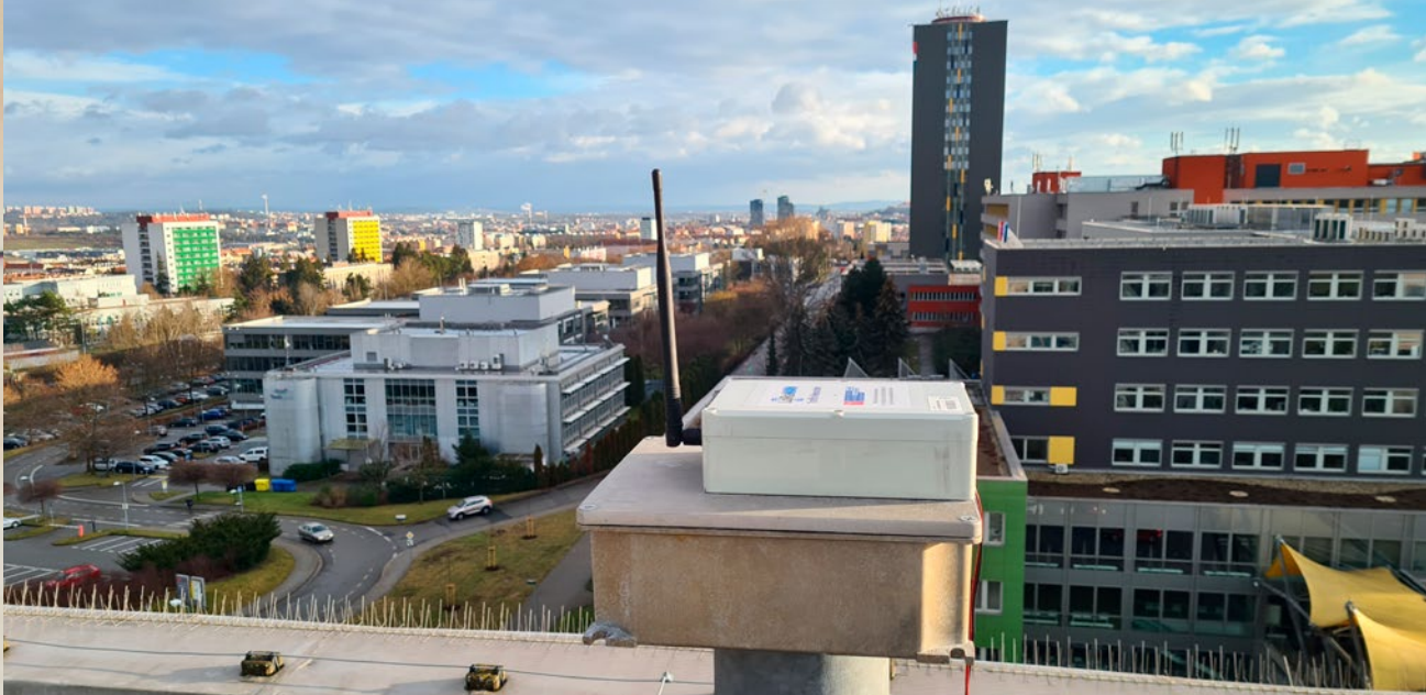
Zařízení LoRaWAN Sniffer, vyvinuté v rámci projektu, na střeše budovy T12 monitorující sítě LoRaWAN v Brně.
