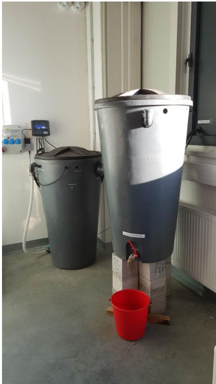
Obr 3: zařízení k čištění šedé vody instalované v centru AdMaS
