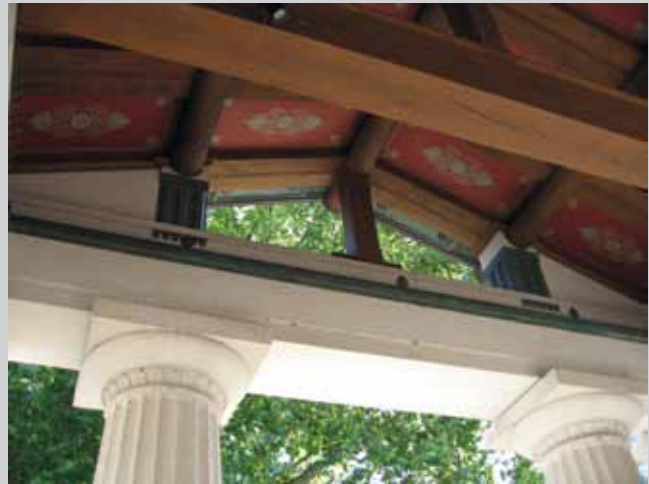
388. John Simpson, Královnina galerie, Buckinghamský palác, Londýn, 1997–2002, detail vstupního portiku v klasickém dórském slohu. J. Simpson, Queen's Gallery, Buckingham Palace, London, 1997–2002, detail of the entrance portico in the classical Doric style.
