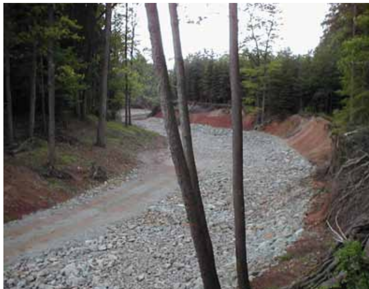
Obr. 3.2 Realizace nového říčního koryta v lesní trati – patrná je provedená stabilizace dna, následovat bude stabilizace břehů, dosadby a napojení úpravy na stávající lesní terén. Úpravy v oblasti řeky Lužnice. Foto M. Šlezinger 2005.
