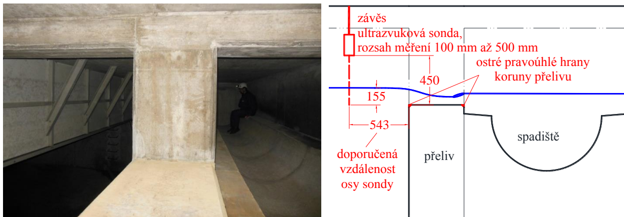
Obr. 6.1 Bezpečnostní přeliv a spadiště RN2EI
