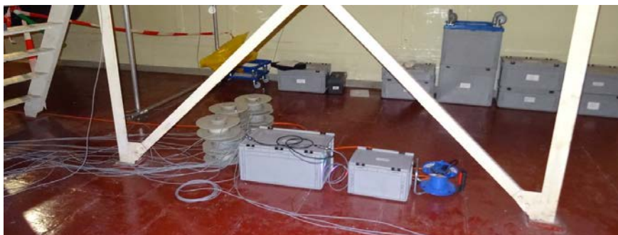
Obr. 44 Pohled na vymezený dočasný sklad v horním plynojemu s měřicí ústřednou a záložním zdrojem po dokončení instalace celého systému.
