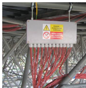
Obr. 25 Měřících ústředn EMS DV 803 osazená v konstrukci zastřešení.
