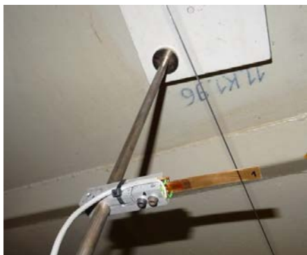
Obr. 42 Nainstalovaný snímač měřicího bodu L1.
