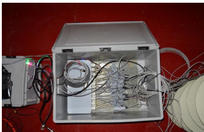
Obr. 41 Měřicí ústředna EMS DV 803 se záložním zdrojem a kabeláží.
