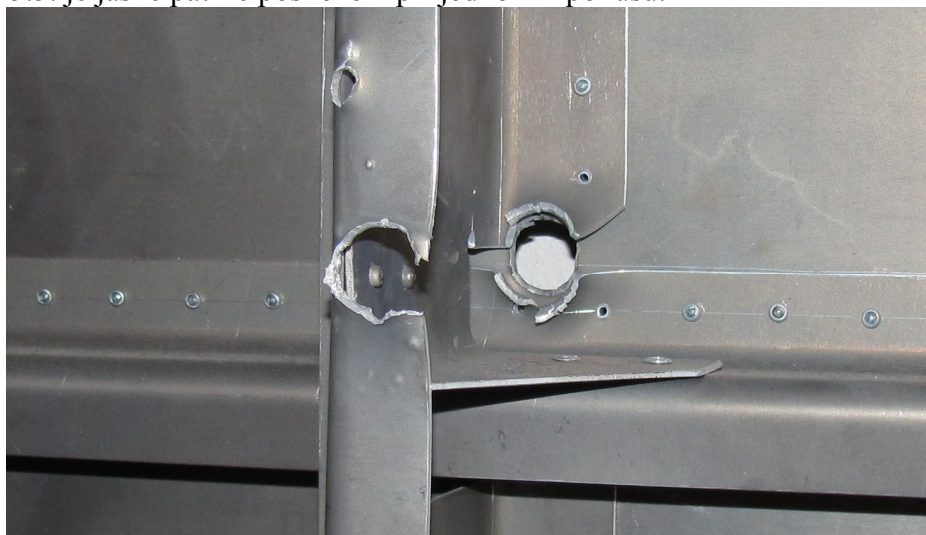
Obr. 5.5. Poškození konstrukce střepinou
