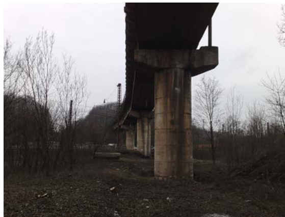
Obr. 5 Most Gagarin před rekonstrukcí – pohled zespodu
