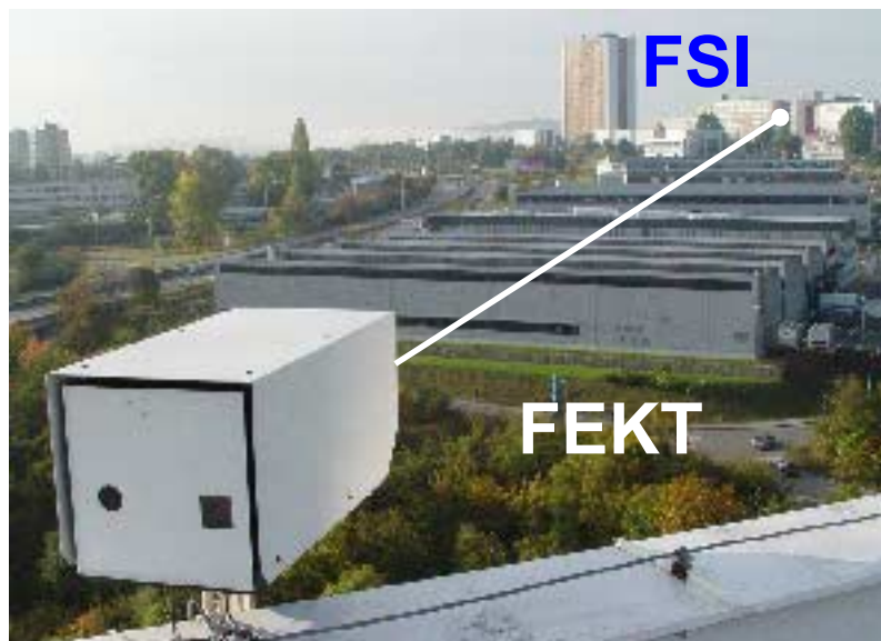
Obr. 3.5 Ukázka instalace spoje ATMO 155 mezi budovami fakult FEKT a FSI
