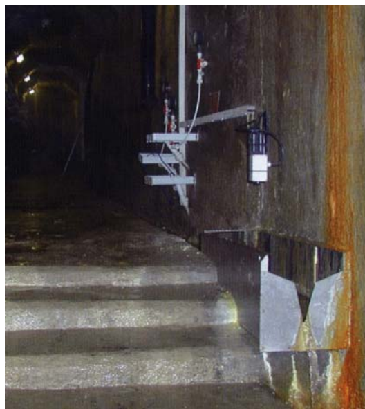
Obr. 16 Kalibrace vestavbové konstrukce s ostrohranným složeným přelivem na hydraulickém žlabu a jeho následné umístění ve štolě VD Morávka pro sledování průtoku prosáklé vody (součást monitorovacího systému TBD)
