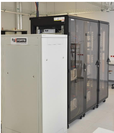
Obr. 11 Skříň s akumulátory a měniči
