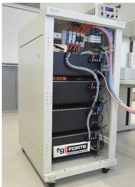
Obr. 10 Rozvaděč s lithiovými akumulátory
