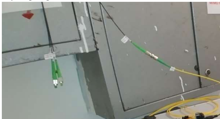
Obr. 6.8: Zakončení optických kabelů v řídicí budově
