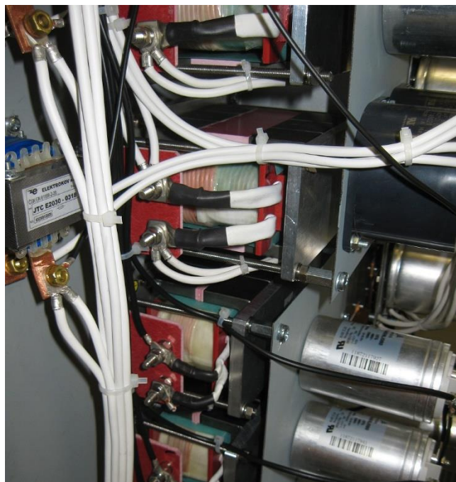
Obr. 22 Část pracovních filtrů měničů (tlumivky a kondenzátory)
