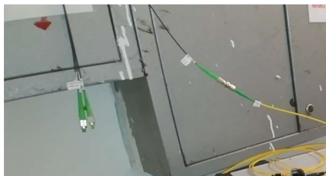
Obr. 5.3: Zakončení optických kabelů v řídicí budově
