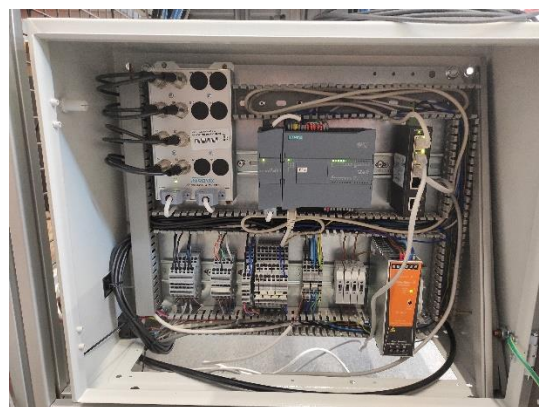
Obr. 15 Detail elektrického rozvaděče
