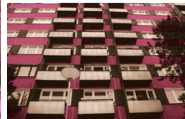
OCELOVÉ BALKONY S PLECHOVOU HLINÍKOVOU MASKOU A VYSOKOU SKLENĚNOU BOĆNICÍ [270] Ulice Miléna (před revitalizací).
