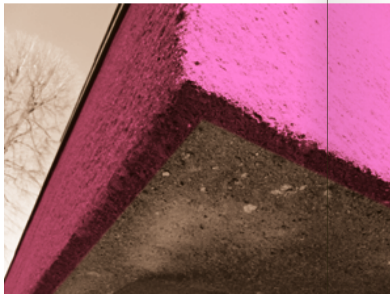
[295] Napojení probarvených a neprobarvených částí v okapní části balkonů.
