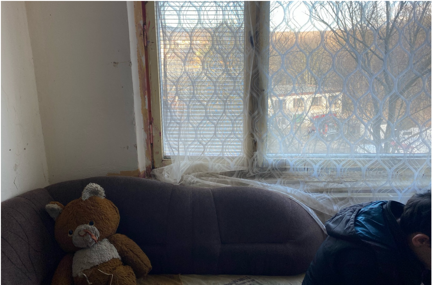
Obr. 4—10, ze sběru důkazů o stavu bytového domu
