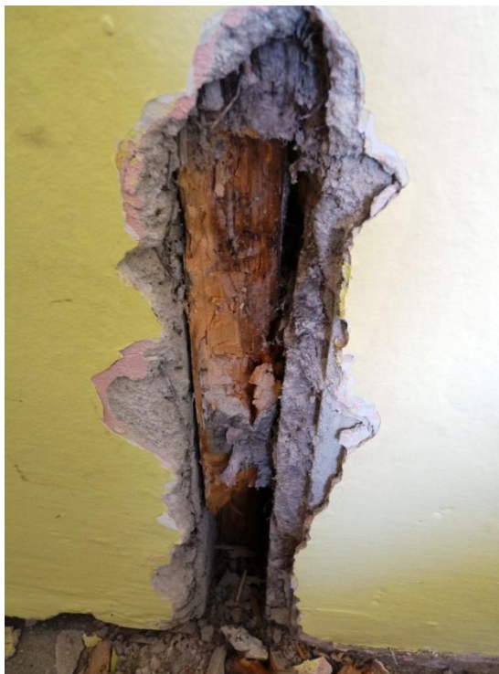
Obr. 39: Pohled na zjištěné zazděné dřevěné zárubně
