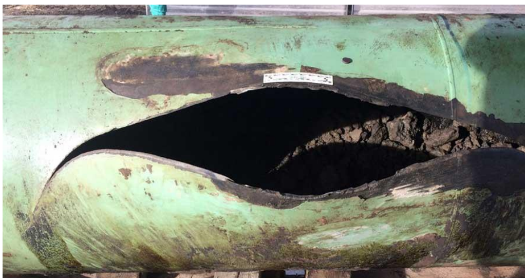
Obr. 10 – Ropné potrubie poškodené následkom únavovej trhliny [14]
