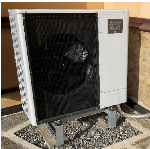
Obr. č. 25: Venkovní jednotka tepelného čerpadla
