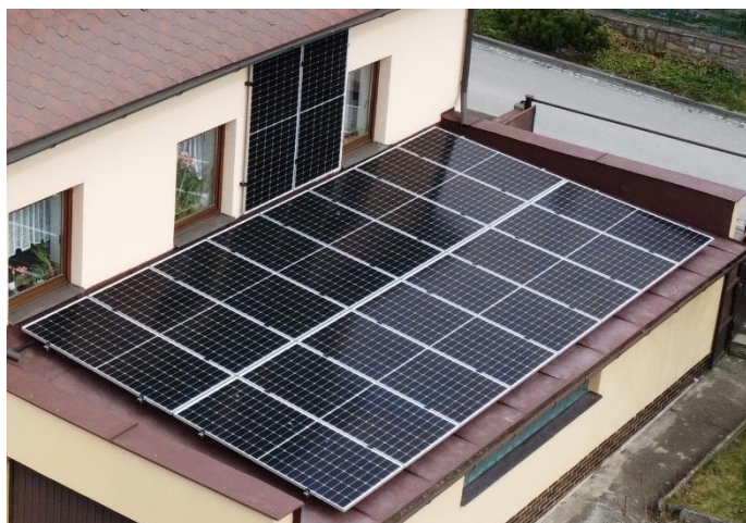
Obr. č. 19: FV panely instalované na objektu RD
