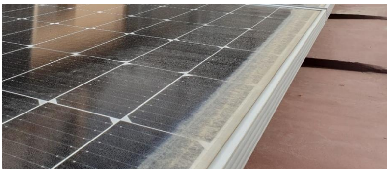
Obr. č. 31: Znečištění FV panelů
